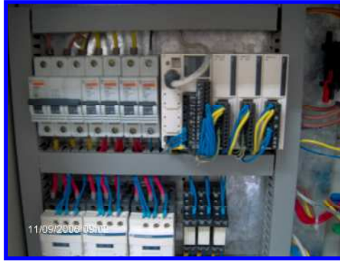
Şekil 12.2. Ömür testi panosu iç görünüm
