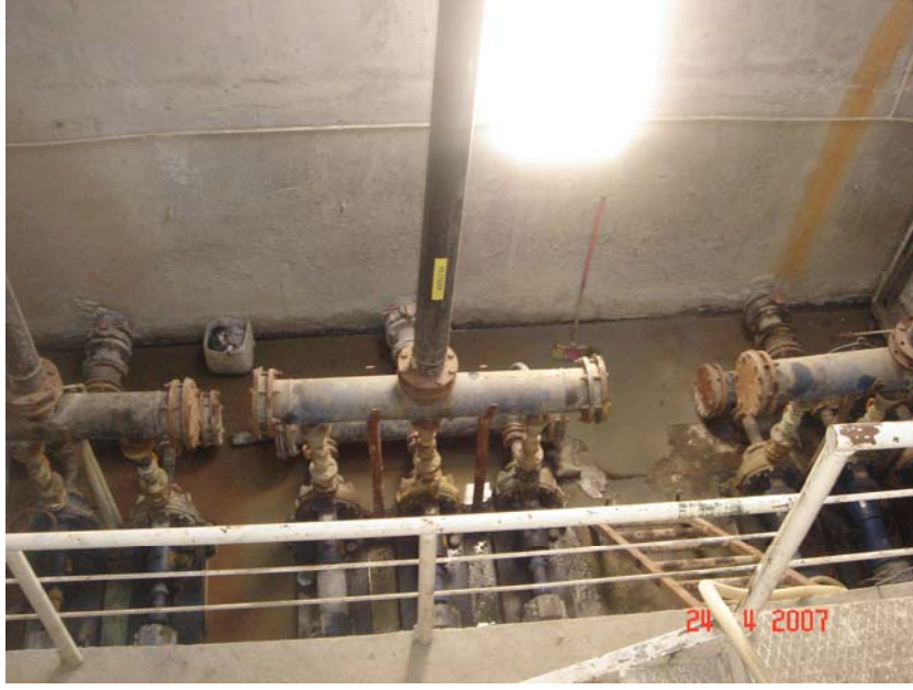
Şekil 2.10. Terfi pompaları yandan görünüşü
