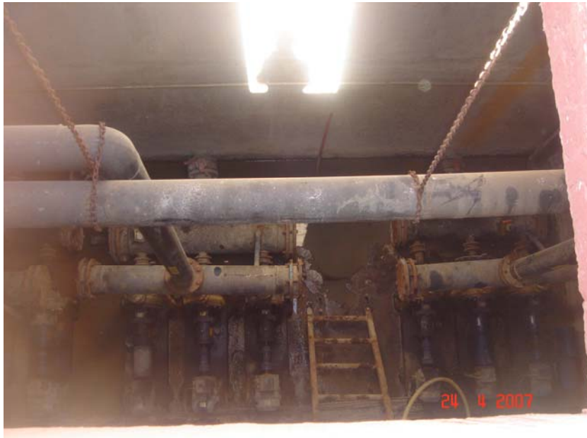
Şekil 2.9. Terfi pompalarının üstten görünüşü
