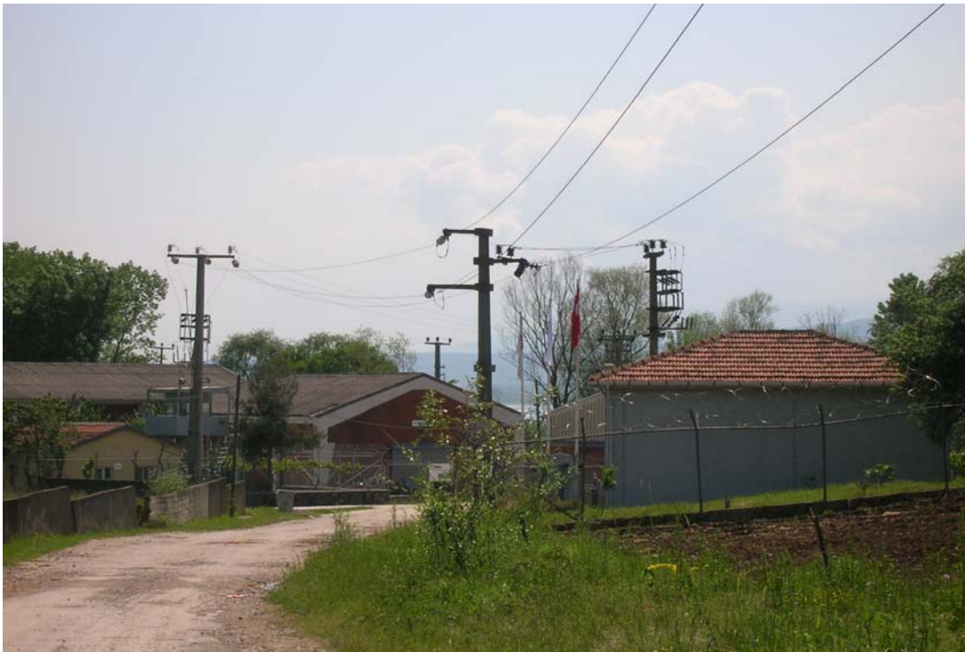
Şekil 4.4. TÜPRAŞ ve PETKİM terfi istasyonlarından görünüm.
