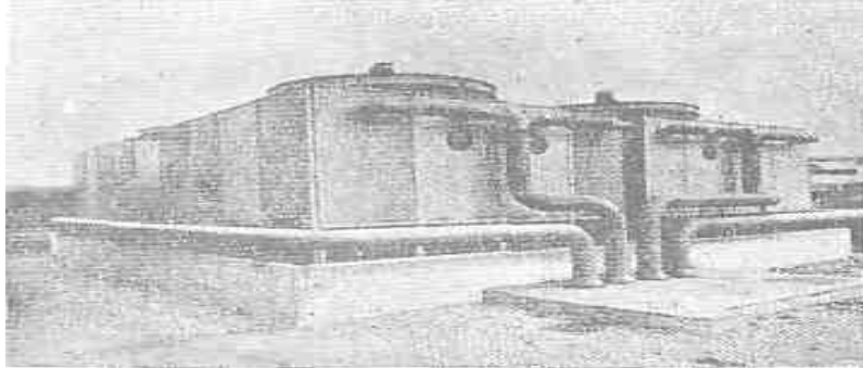
Şekil 2.14 4 üniteden oluşan bir soğutma grubu [25]
