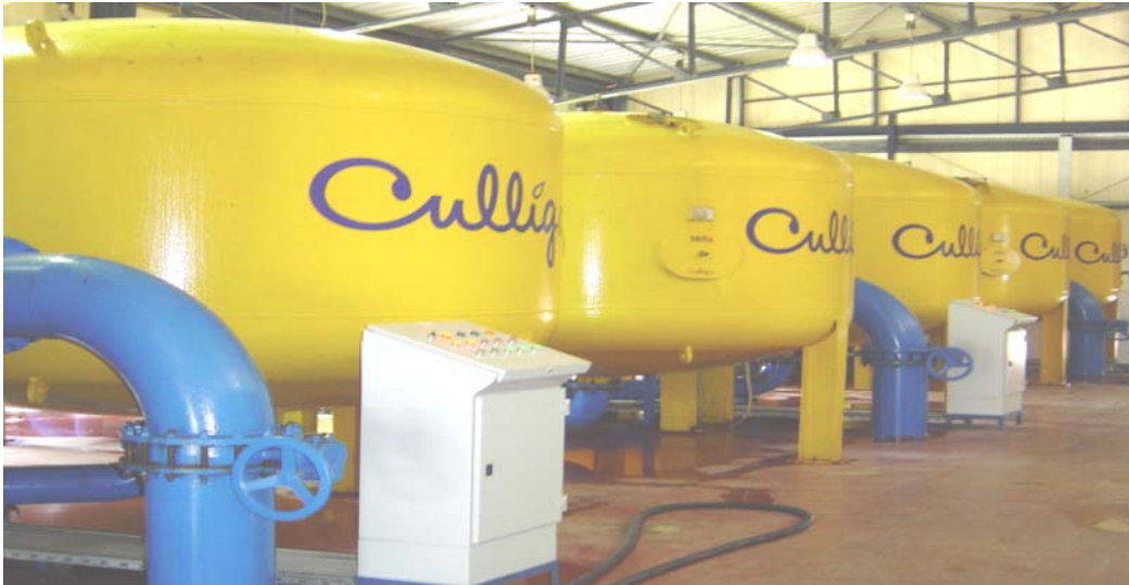
Şekil 2.9. Maltepe İçmesuyu Arıtma Tesisi basınçlı kum filtreleri
