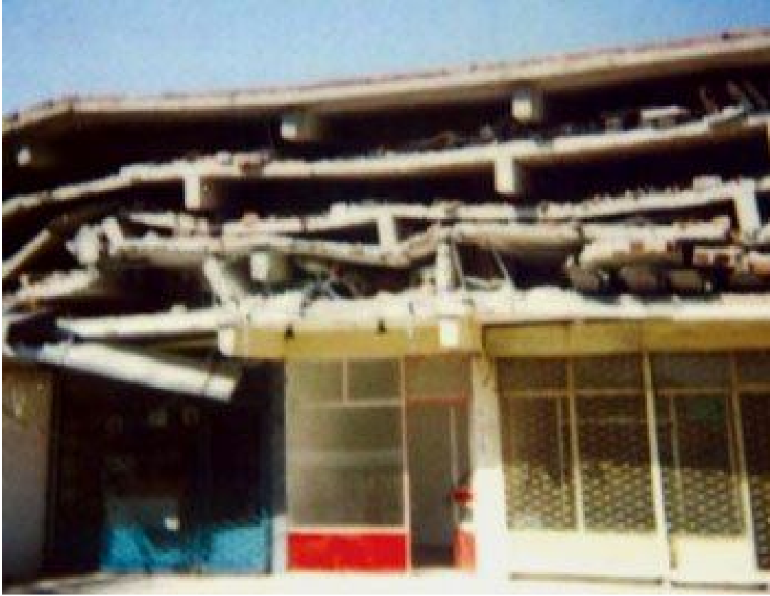
Şekil 3.7. Zemin katta kısmen güçlü kolonların kullanıldığı zayıf kolon, güçlü kiriş etkisi altında yıkılmış bir bina
