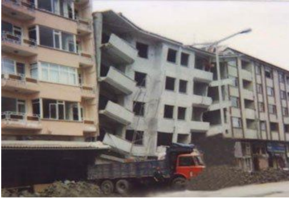
Şekil 3.17 Çekişleme etkisinde yıkılmış bir bina (3)
