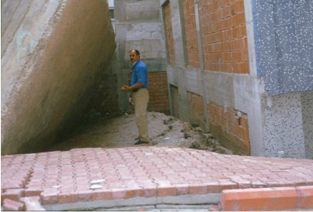
Şekil 3.19 Zemin sıvılaşmasından dolayı yıkılmış bina örneği
