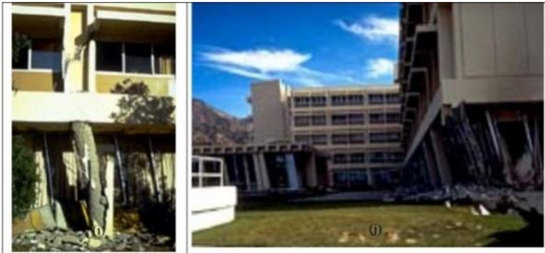
Şekil 3.18 Yumuşak kattan dolayı yıkılmış bina örnekleri
