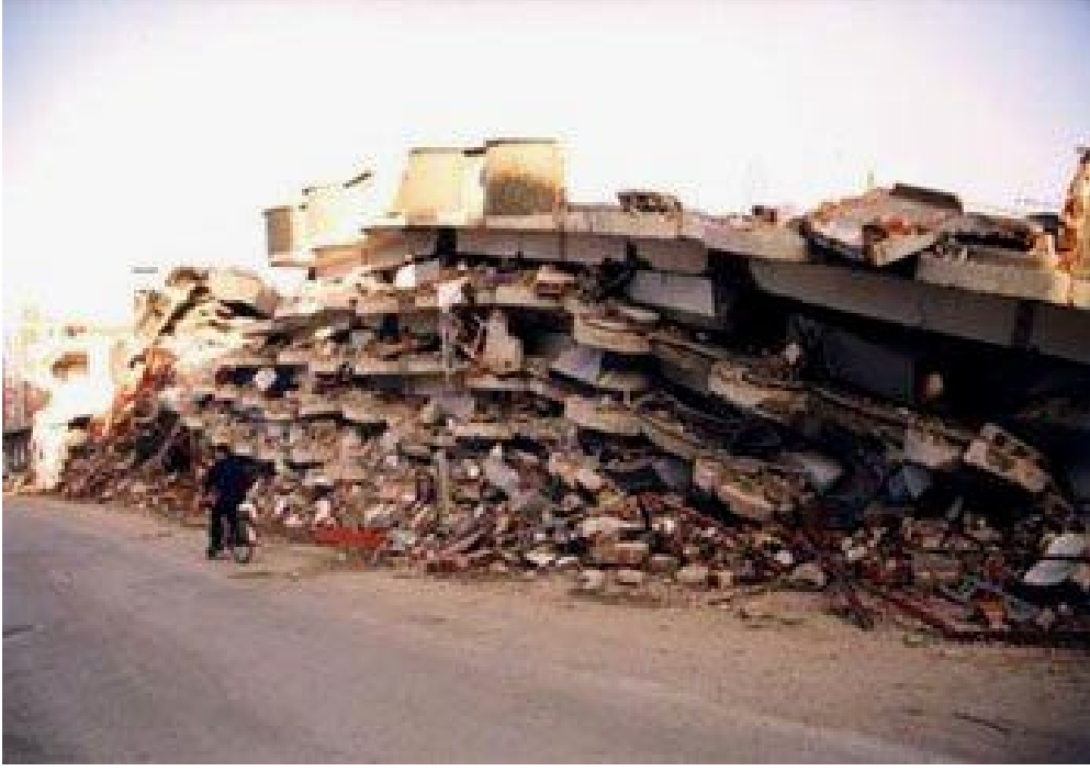
Şekil 3.6 Zayıf kolon, güçlü kiriş etkisi altında yıkılmış bir bina
