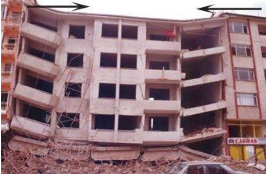
Şekil 3.15 Çekişleme etkisinde yıkılmış bir bina (1)
