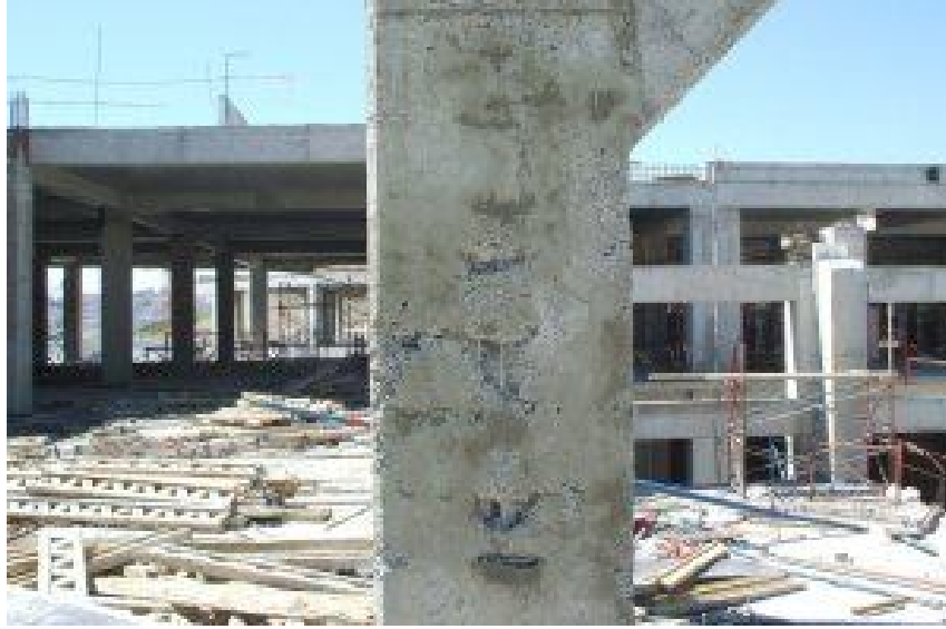
Şekil 3.9 Uygun olmayan agrega ve yetersiz beton kullanılmış bir bina
