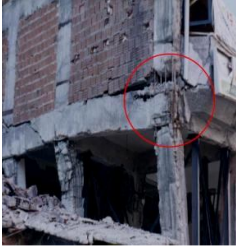
Şekil 3.13 Birleşim yerinde hasar oluşmuş bir bina
