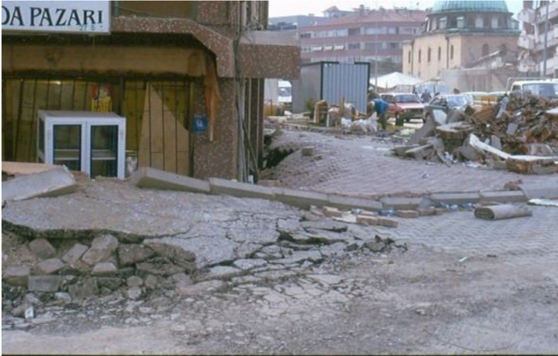
Şekil 3.20 Zemin sıvılaşması örneği
