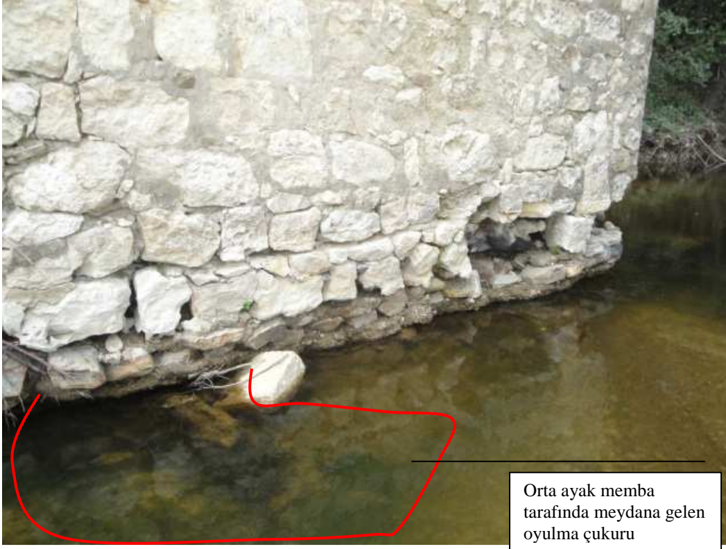
Fotoğraf 5. Yıkılan Laladere köprüsü, orta ayak etrafında meydana gelen oyulma
