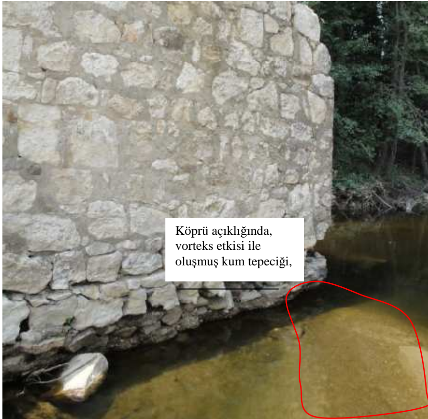
Fotoğraf 6. Yıkılan Laladere köprüsü, orta ayak etrafında meydana yığılma
