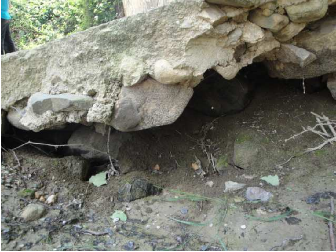
Fotoğraf 8. Yıkılan Laladere köprüsü, kenar ayak tabanında meydana gelen oyulma
