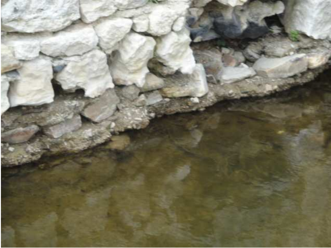
Fotoğraf 4. Yıkılan Laladere köprüsü, orta ayak etrafında meydana gelen oyulma
