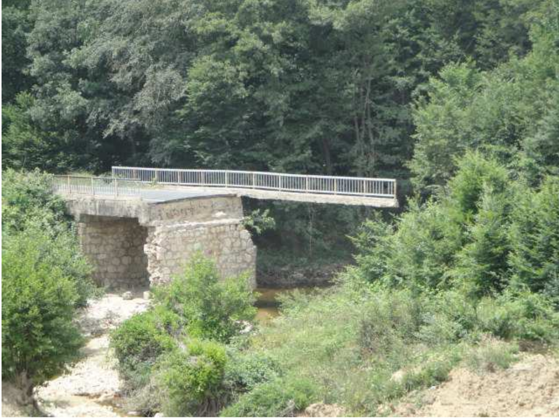
Fotoğraf 3. Yıkılan Laladere köprüsü, mansaptan bakış
