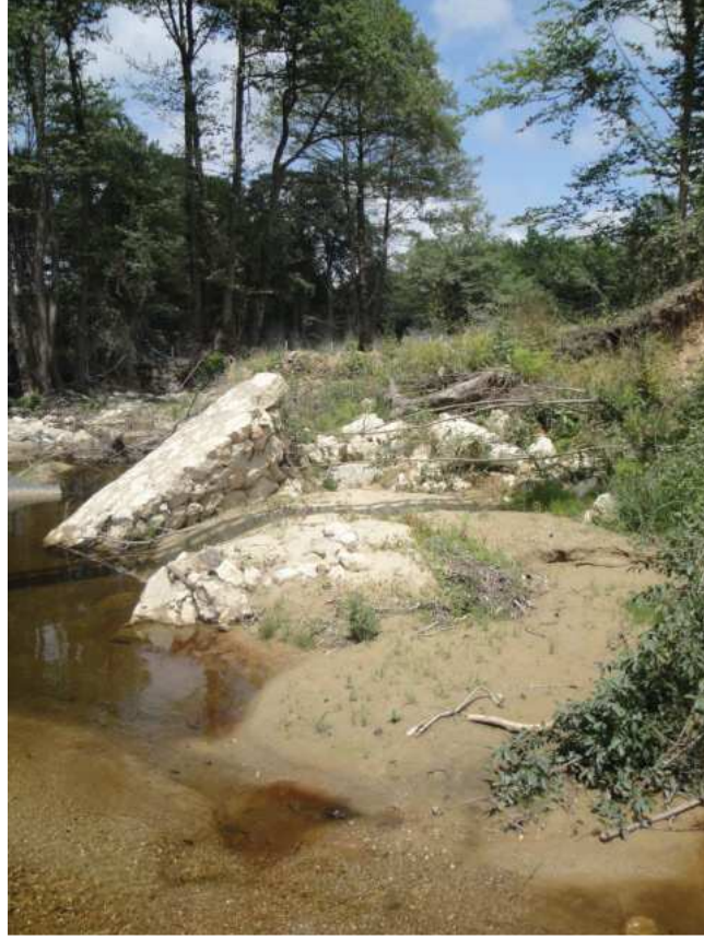
Fotoğraf 7. Yıkılan Laladere köprüsü, akım etkisi ile yerinden sökülen kenar ayak
