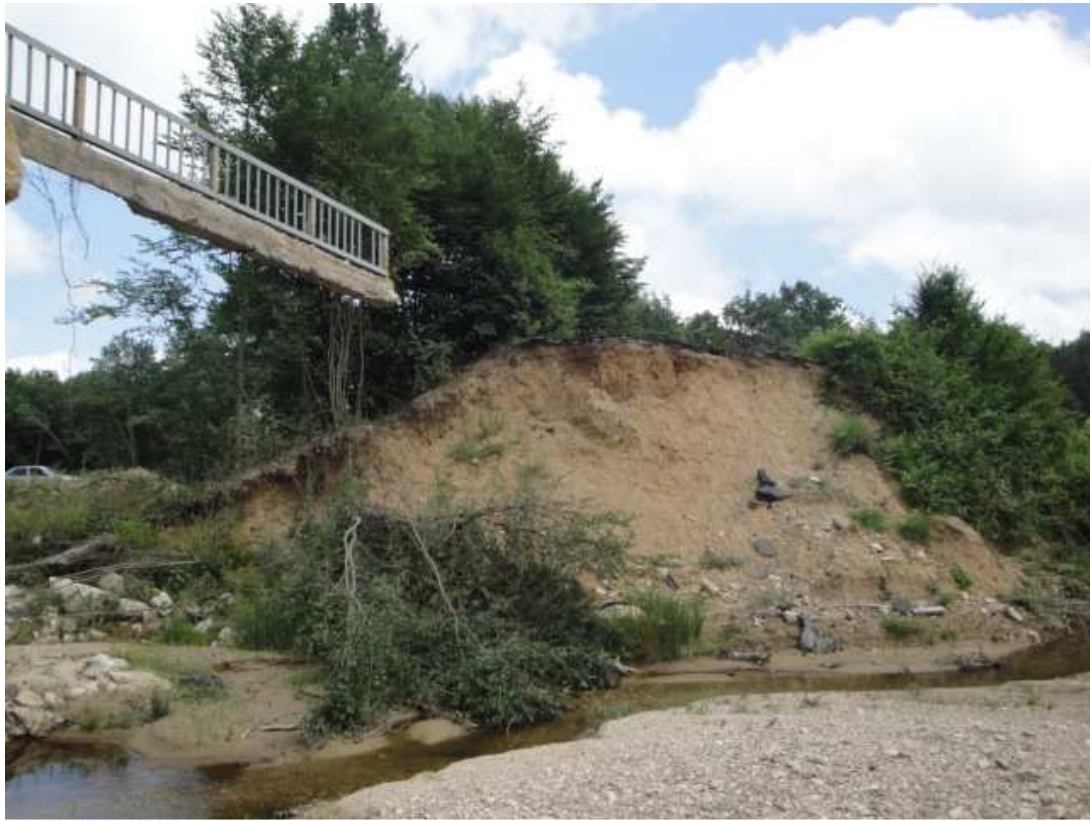
Fotoğraf 8. Yıkılan Laladere köprüsü, yıkılan kenar ayak
