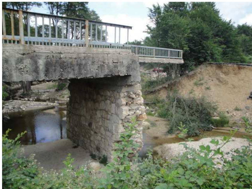
Fotoğraf 2. Yıkılan Laladere köprüsü, mansaptan bakış
