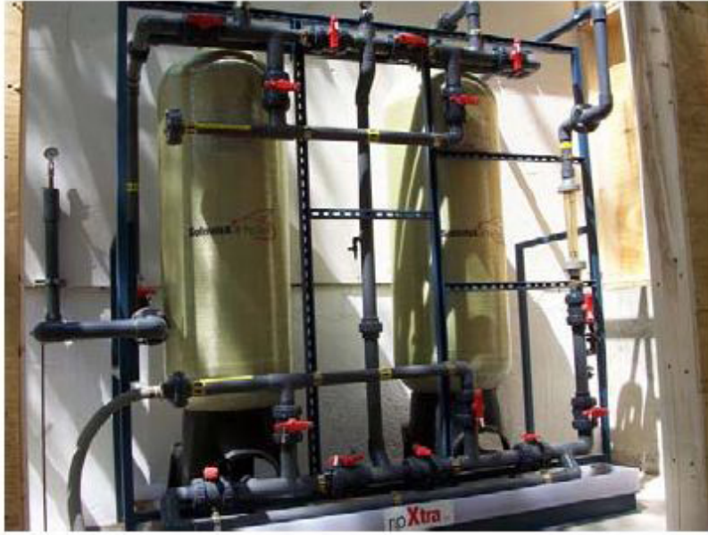
Şekil 2.7. PES arsenik giderim sistemi (Turkey Hills apartmanları)
