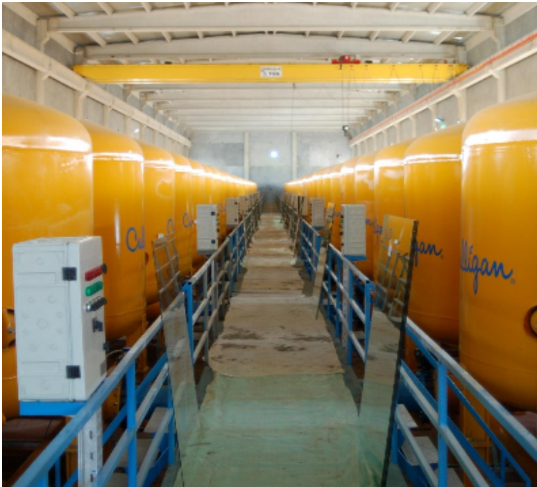
Şekil 2.1. İzmir arsenik arıtma tesisinden bir görünüm
