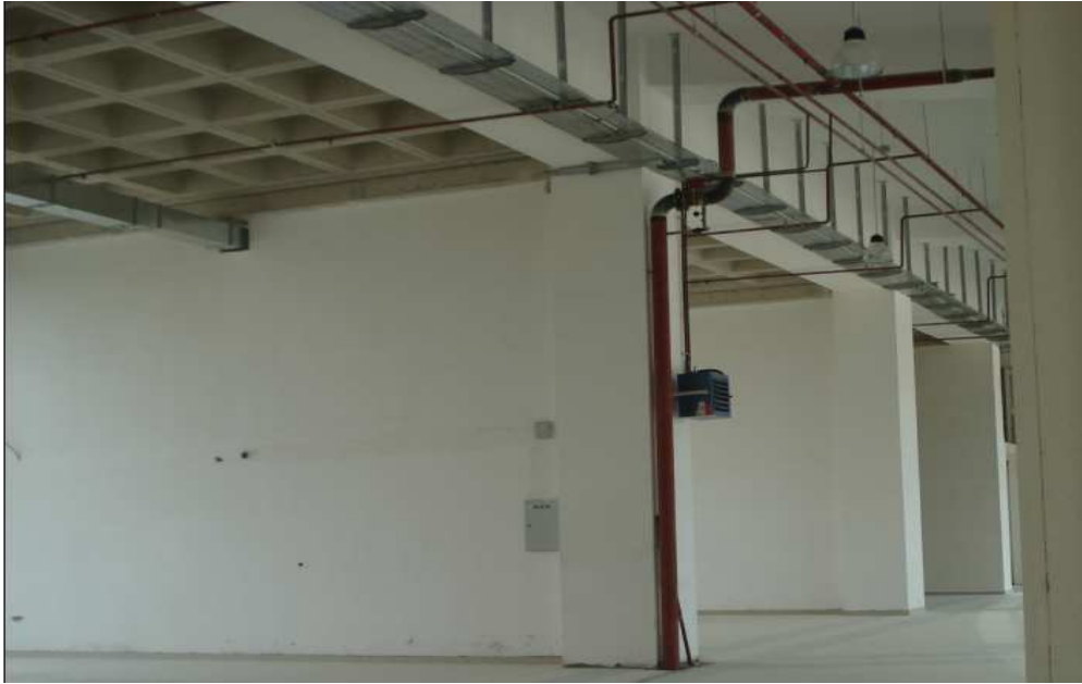
Şekil A.2. Örnek binadaki ısı apareyi ve ısıtma tesisatı
