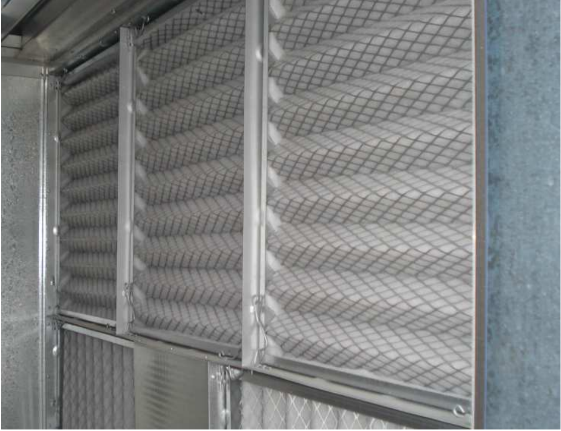
Şekil A.13. Örnek binadaki klima santrali torba filtreleri
