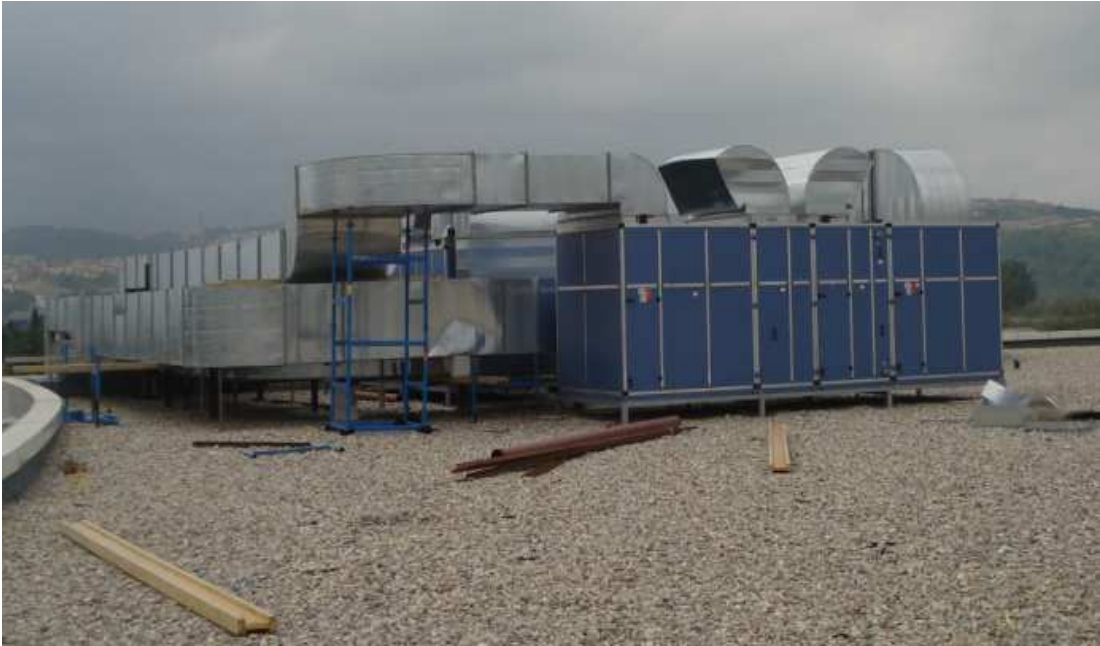
Şekil A.10. Örnek binadaki klima santralleri
