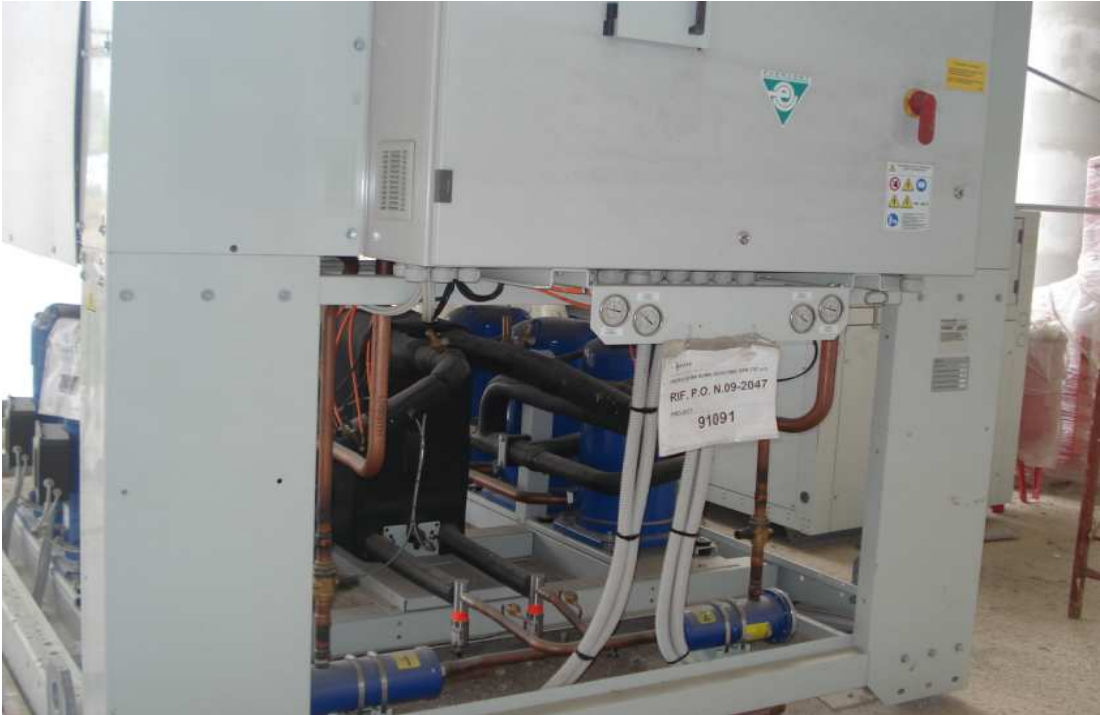
Şekil A.22. Örnek binadaki chiller grubu
