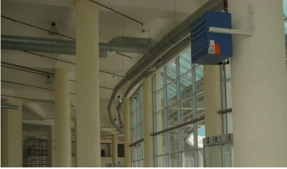
Şekil A.5. Örnek binadaki ısı apareyi ve havalandırma sistemi
