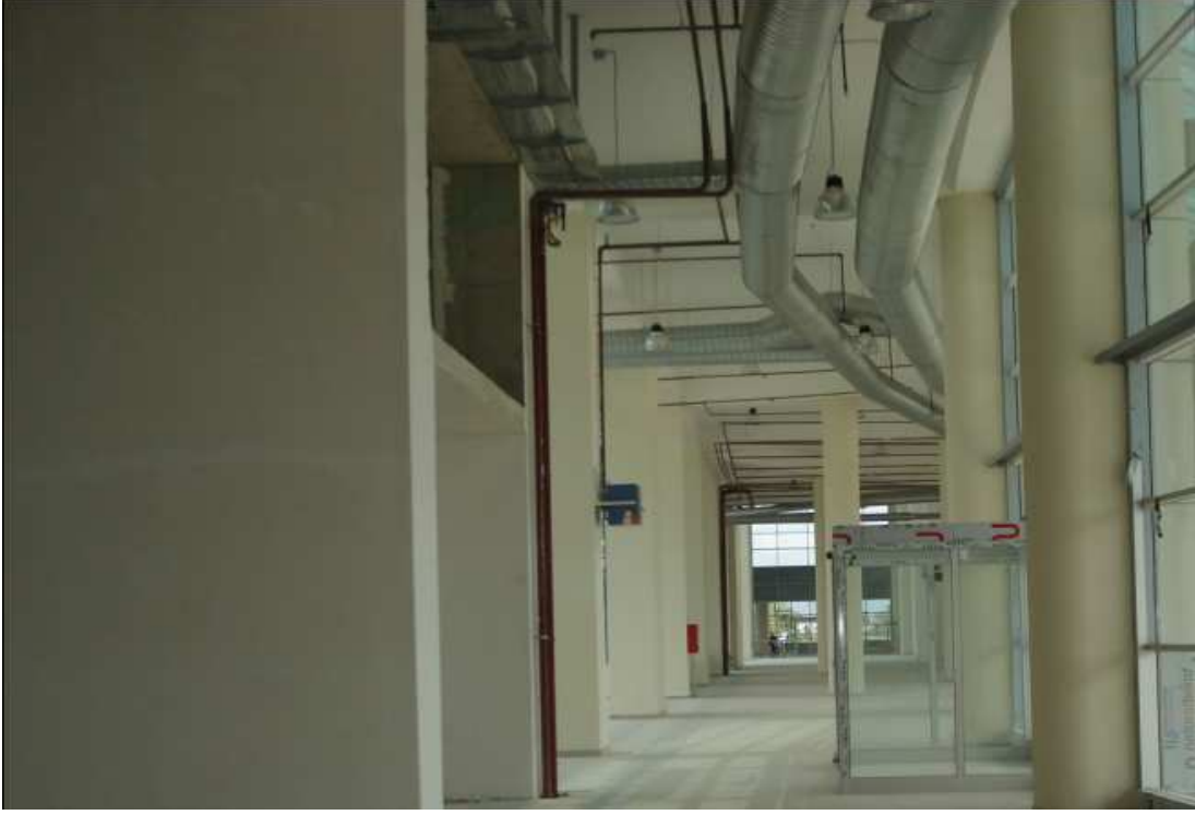
Şekil A.3. Örnek binadaki ısıtma ve havalandırma sistemi
