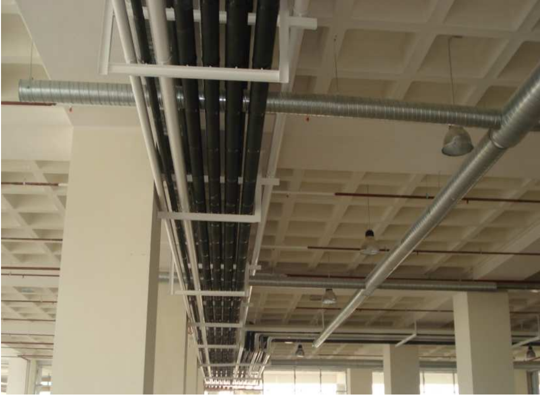
Şekil A.17. Örnek binadaki ısıtma ve havalandırma tesisatı 3
