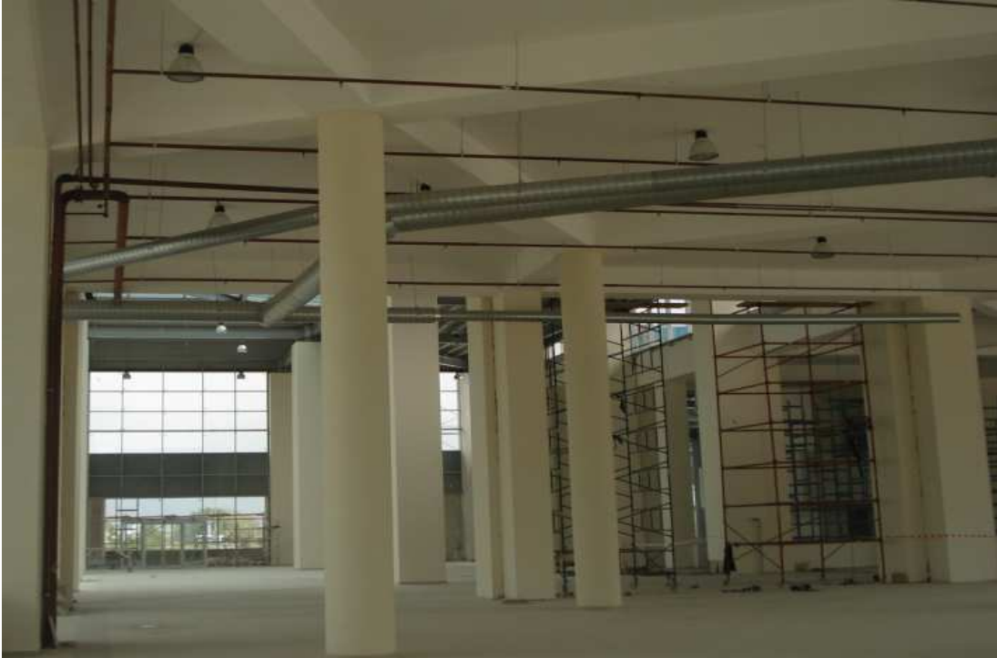
Şekil A.4. Örnek binadaki ısıtma ve havalandırma sistemi 2
