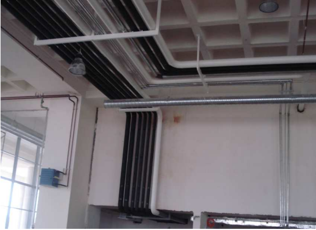
Şekil A.19. Örnek binadaki ısıtma tesisatı
