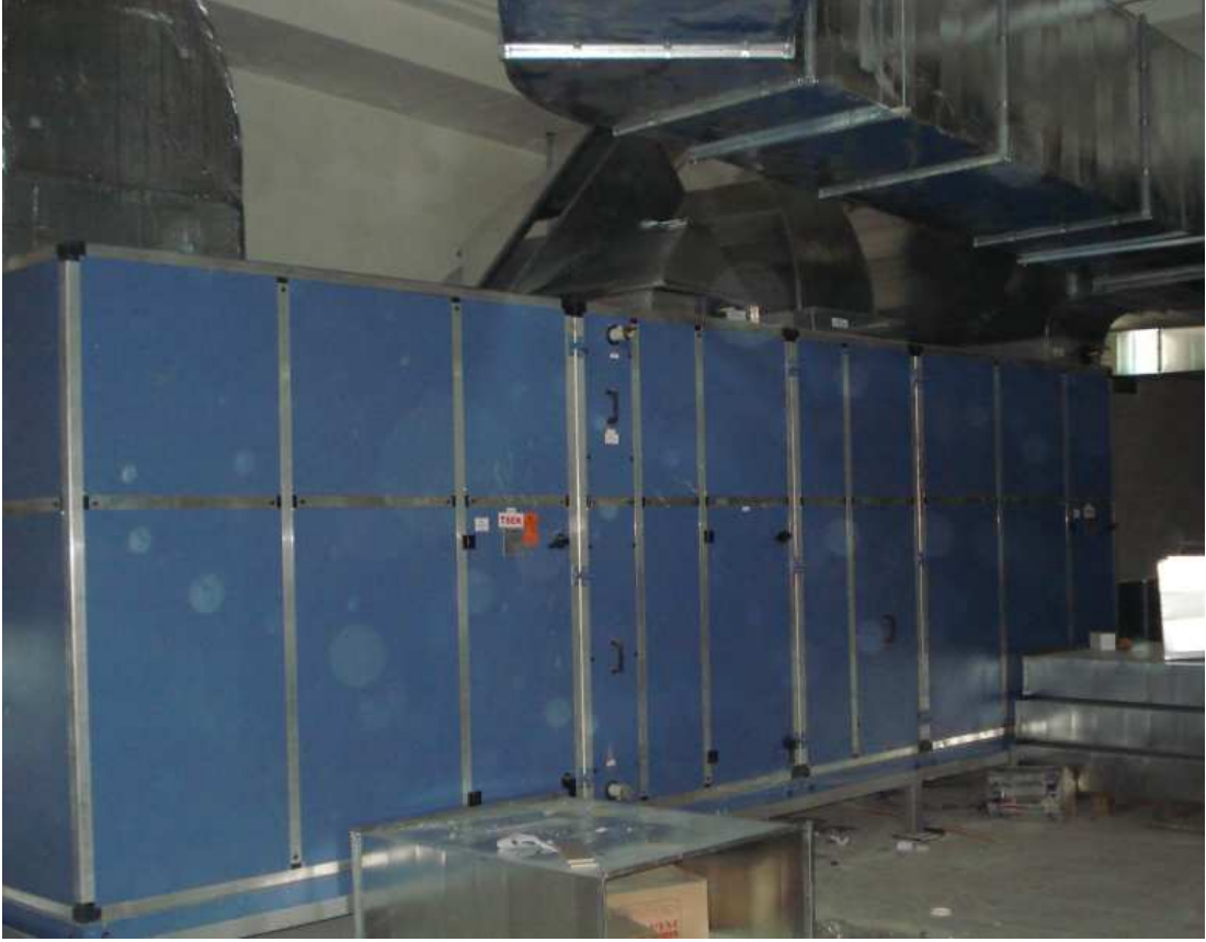
Şekil A.9. Örnek binadaki klima santrali
