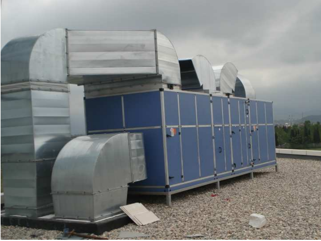
Şekil A.11. Örnek binadaki klima santrali 2
