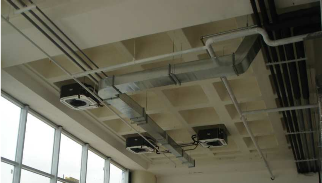
Şekil A.8. Örnek binadaki 4 way tavan tipi fan-coil ve havalandırma sistemi
