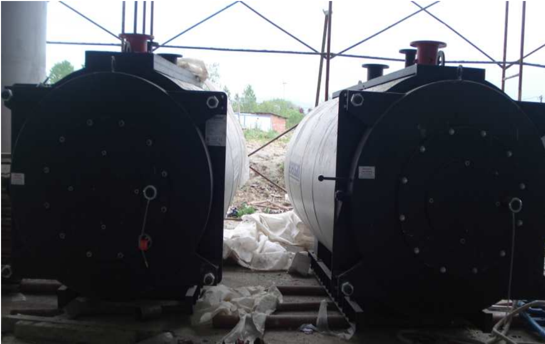
Şekil A.20. Örnek binadaki kazanlar
