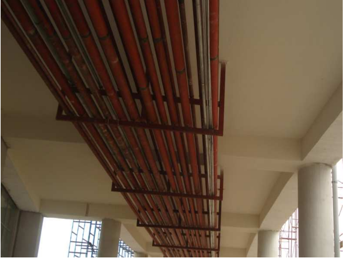
Şekil A.21. Örnek binadaki ısıtma tesisatı boruları
