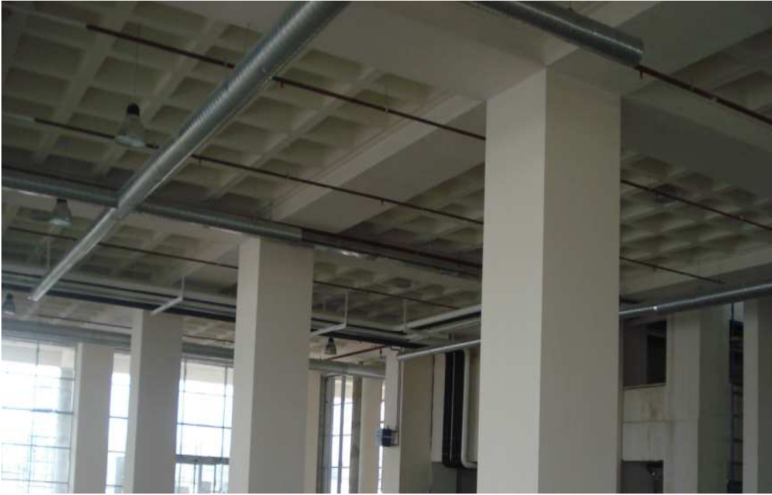
Şekil A.18. Örnek binadaki ısıtma ve havalandırma tesisatı 4
