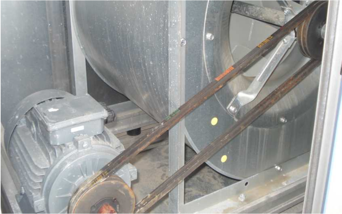
Şekil A.14. Örnek binadaki klima santrali vantilatör/aspiratör ünitesi
