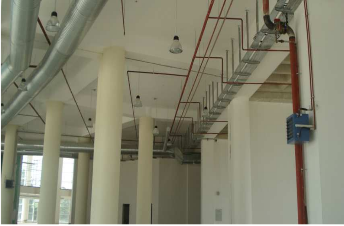
Şekil A.15. Örnek binadaki ısıtma ve havalandırma tesisatı
