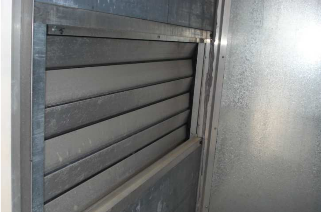
Şekil A.12. Örnek binadaki klima santrali hava damperi
