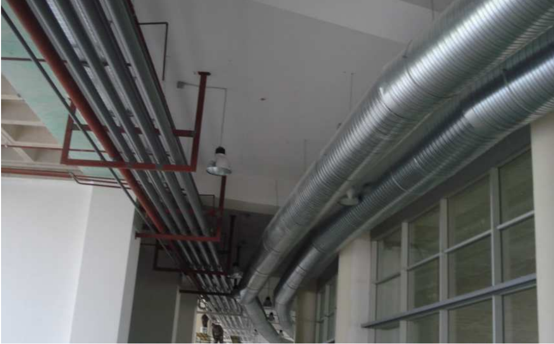
Şekil A.16. Örnek binadaki ısıtma ve havalandırma tesisatı 2
