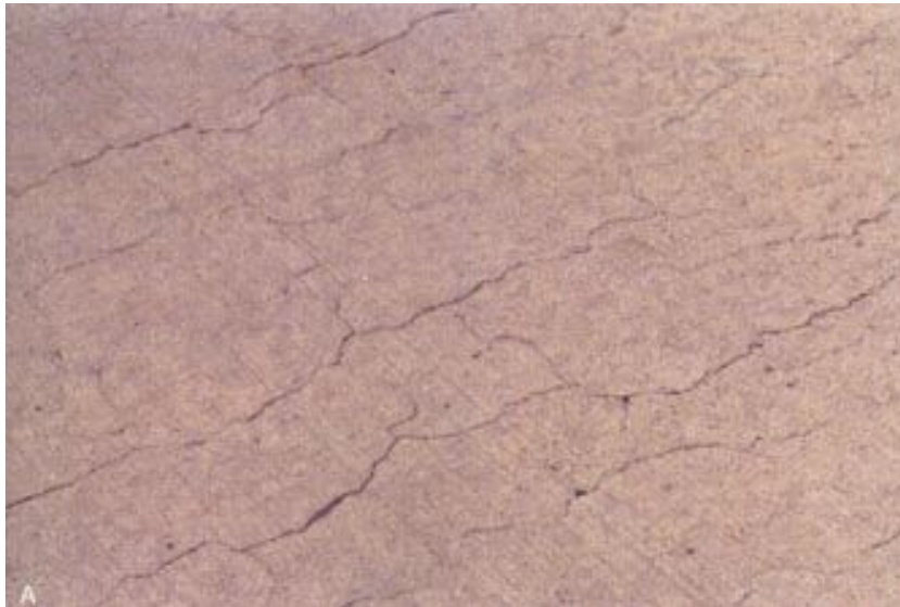
Şekil 3.12. ASR hasarına bağlı olarak oluşan çatlaklar
