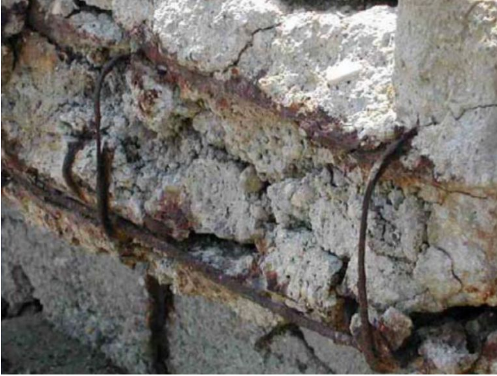
Şekil 3.7. Korozyon sonucu donatıların zarar görmesi
