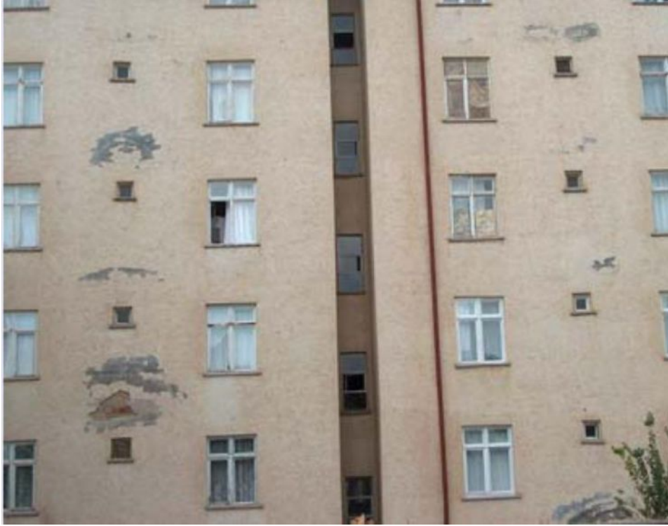
Şekil 3.3. Tasarım sürecinde gerekli su yalıtımının düşünülmemesi sonucu görülen hasarlar
