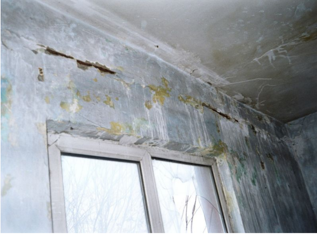
Şekil 3.11. Donatı korozyonu sonucu donatının açığa çıkması
