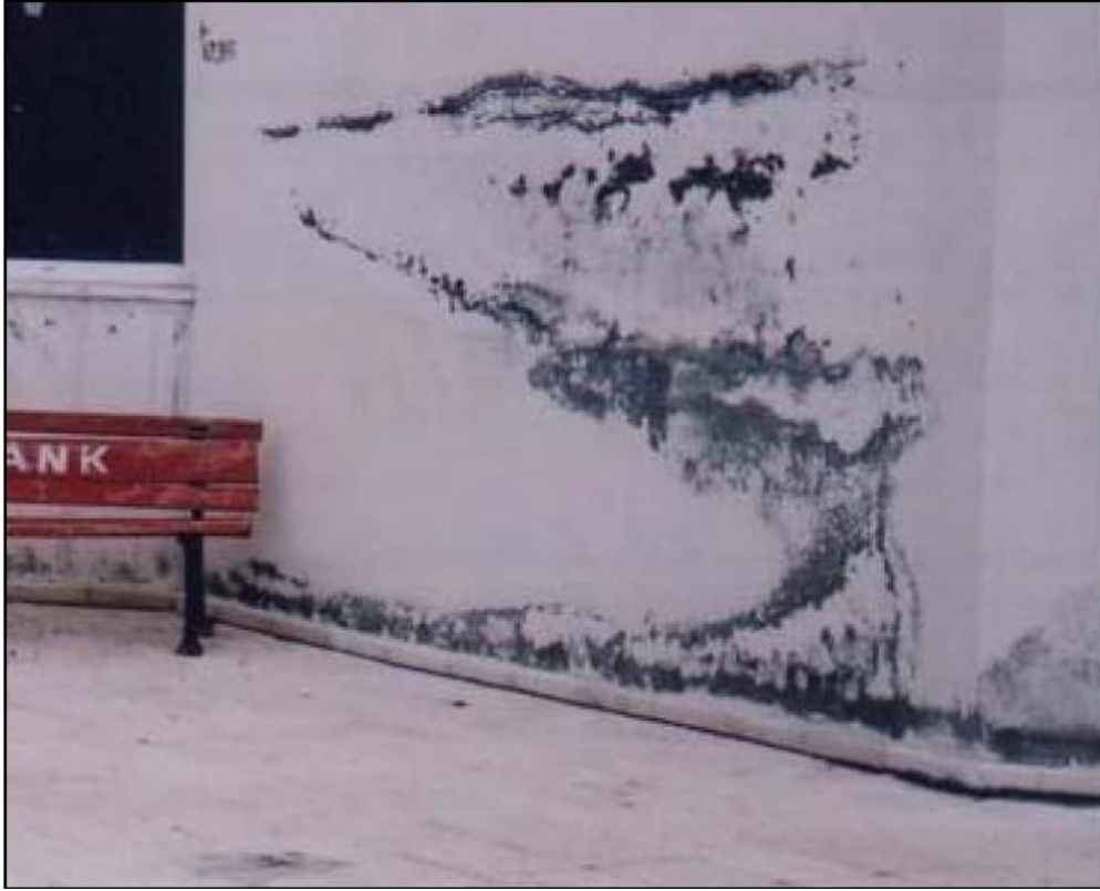
Şekil 3.6. Gerekli yalıtımın yapılmaması sonucunda zarar gören yapı
