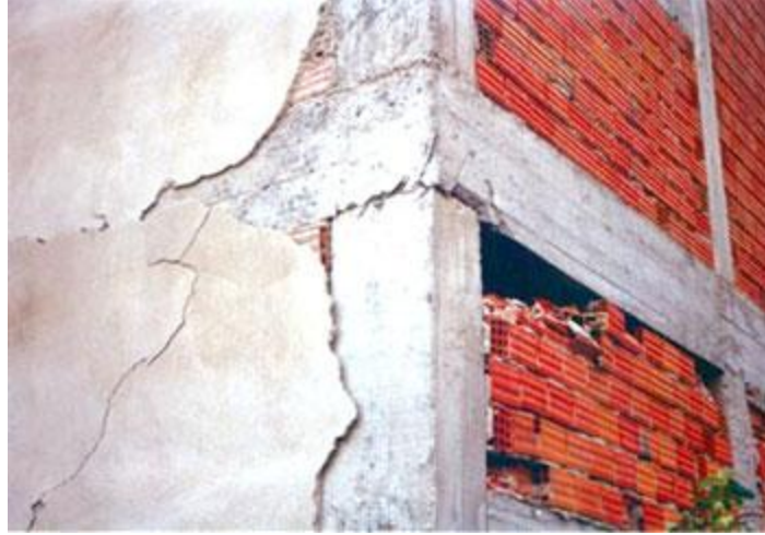
Şekil 1.22. Kalitesiz Beton Kullanımı - 3
