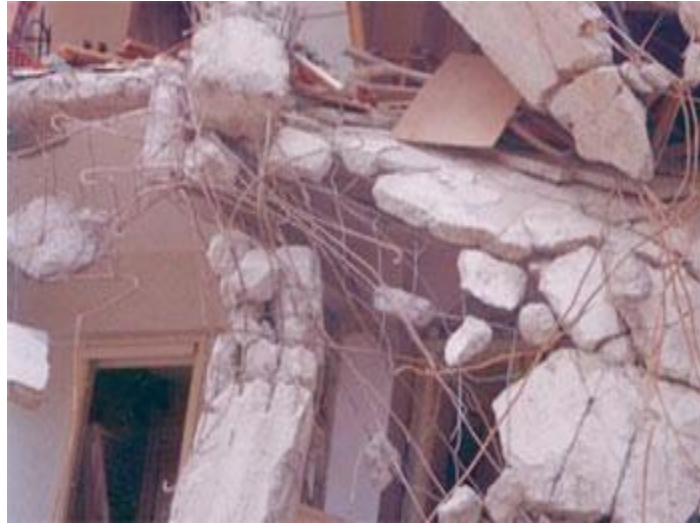
Şekil 1.20. Kalitesiz Beton Kullanımı - 1
