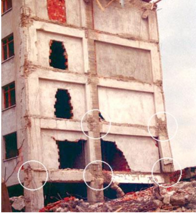
Şekil 1.13. Düğüm Noktalarında Etriye Sıklaştırılması Yapılmaması
