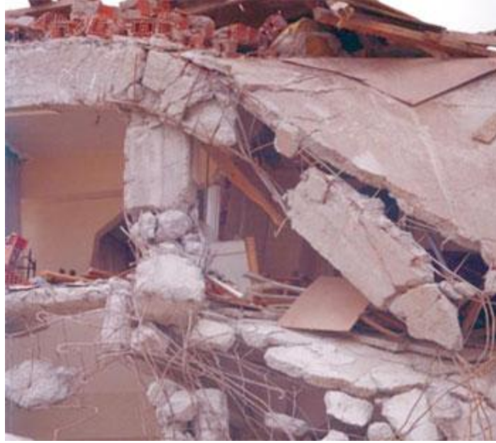
Şekil 1.21. Kalitesiz Beton Kullanımı - 2
