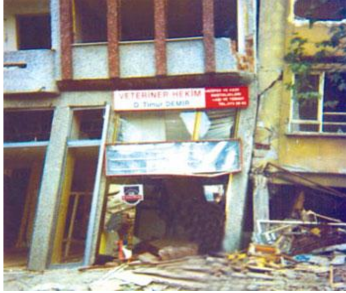
Şekil 1.18. Zemin Kat Kolonlarında Mafsallaşma
