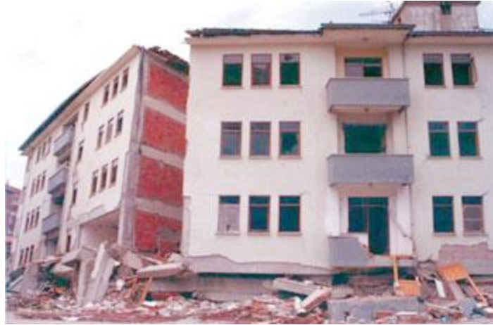
Şekil 1.5. Yumuşak kat örneği - 2
