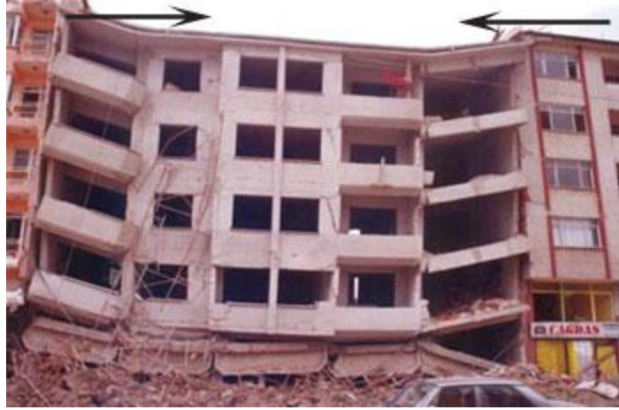
Şekil 1.8. Dilatasyon Derz Boşluğu Bırakılmaması - 1
