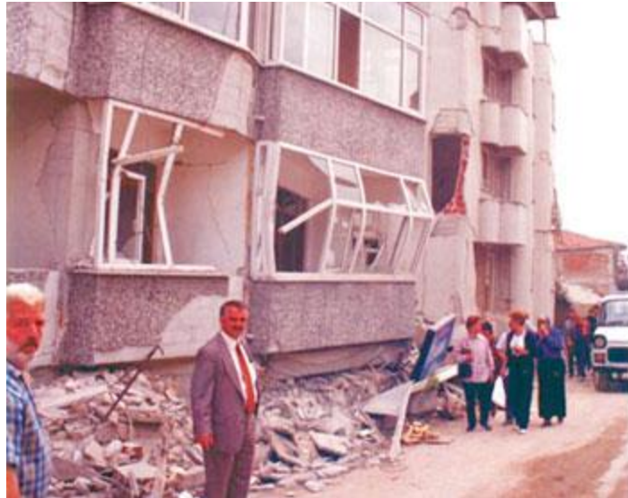
Şekil 1.12. Zemin ve Asma Katta Bölme Duvarların Olmaması
