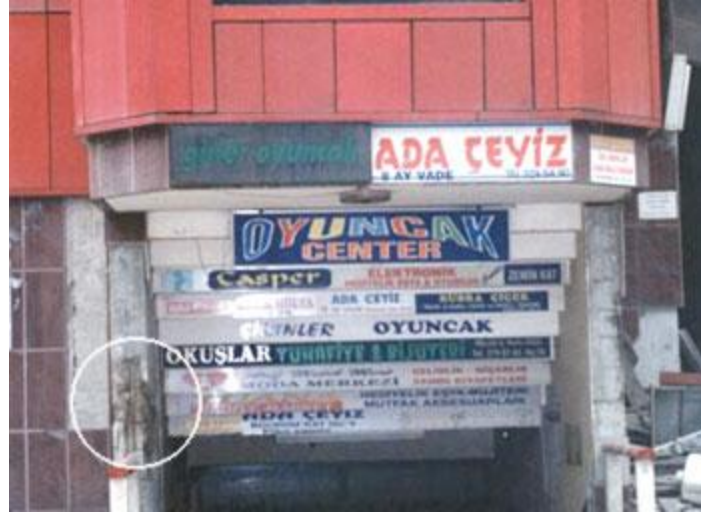
Şekil 1.1. Taşıyıcı sistemde işçilik ve donatı yerleştirme kusurları -1
