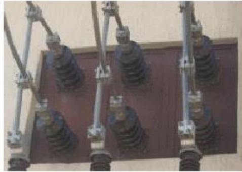
Şekil 4.1. Hariçten dâhile geçiş için kullanılan geçit izolatörleri
