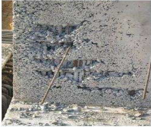
Şekil 2.1. Segregasyona uğramış kolon
