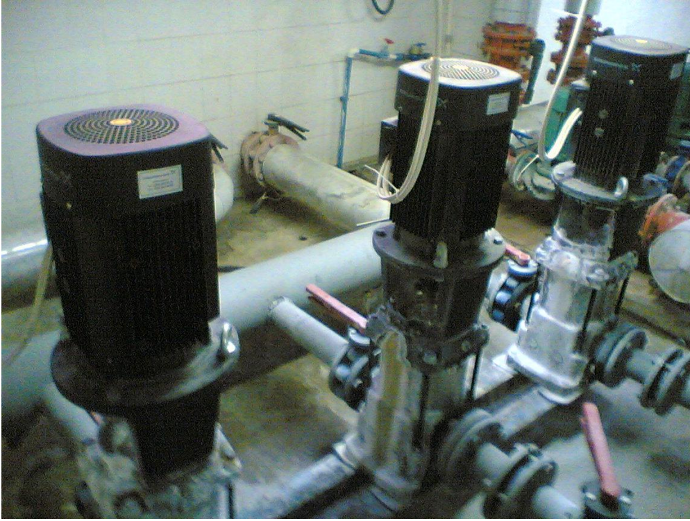
Şekil 4.13. Kuzuluk kaplıcasının kireçlenmiş sirkülasyon pompaları.
