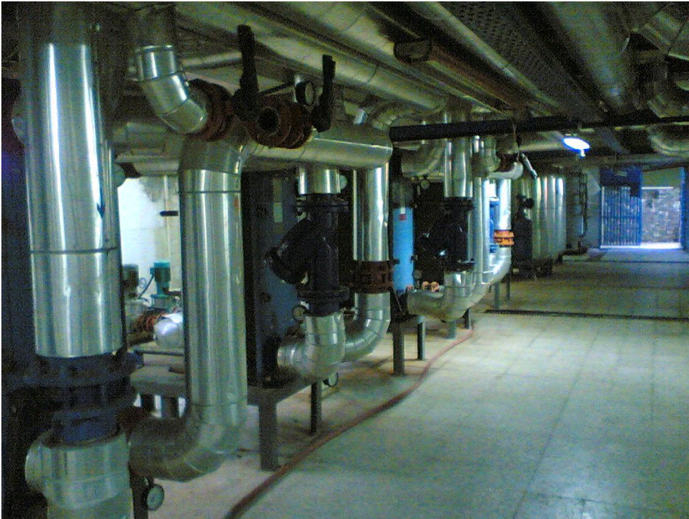
Şekil 4.9. Kuzuluk kaplıcasının kazan dairesi.
