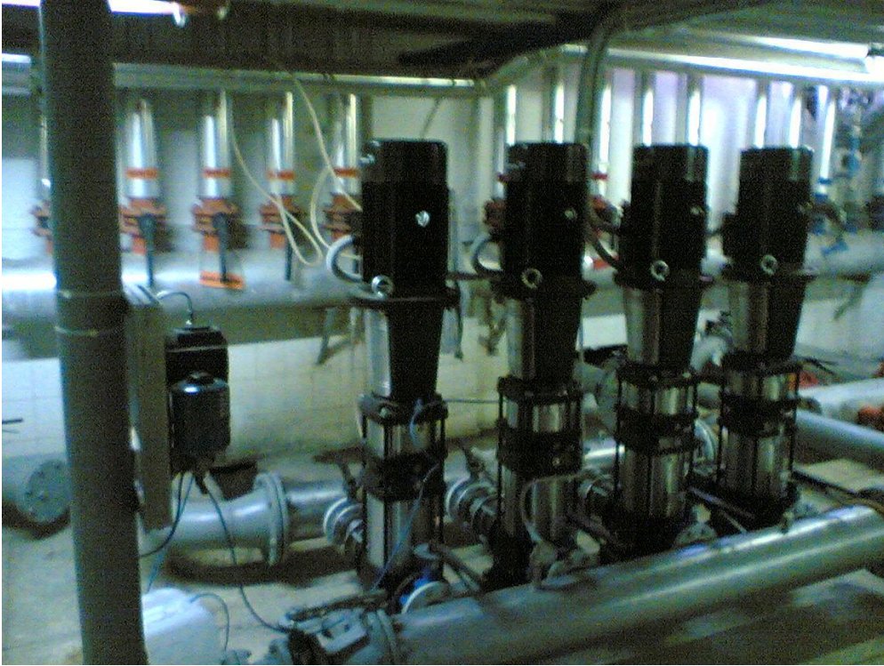
Şekil 4.14. Kuzuluk kaplıcasının yeni sistem sirkülasyon pompaları.
