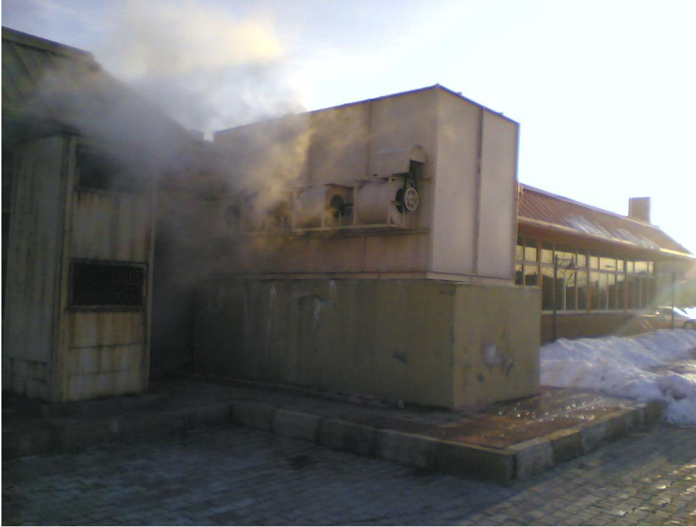
Şekil 4.11. Kuzuluk kaplıcasının soğutma kuleleri.
