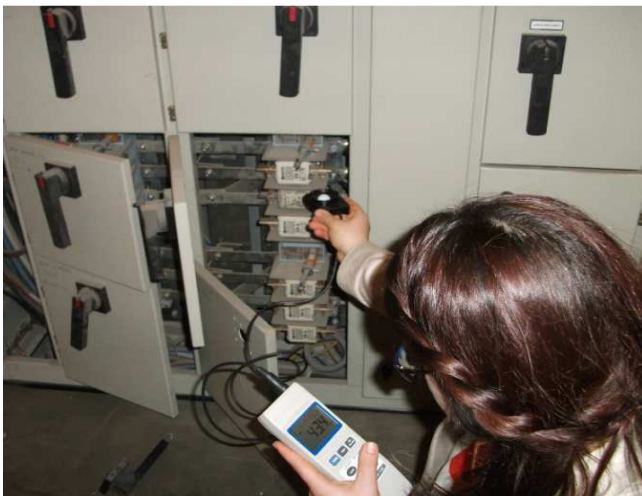
Şekil 5.2. Bir dağıtım merkezinde AG panosu bıçaklı sigorta önü ölçüm
