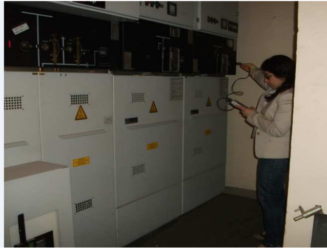
Şekil 5.1. Bir dağıtım merkezinde OG hücre önü ölçüm
