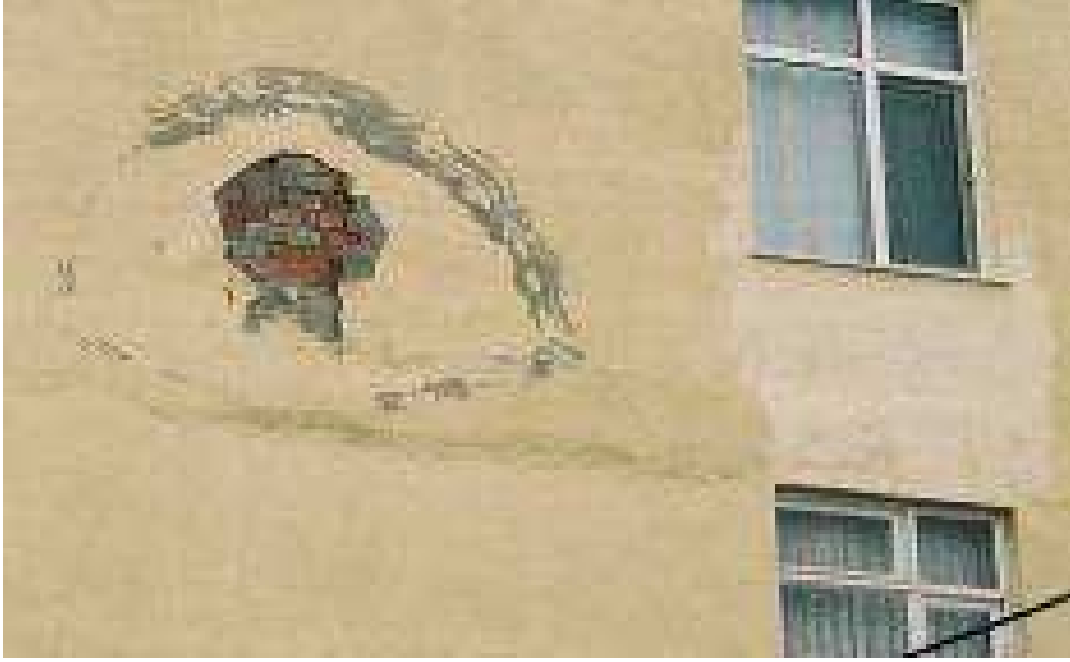
Şekil 2.7. İç mekanlardan sızan suyun sıvayı bozması
