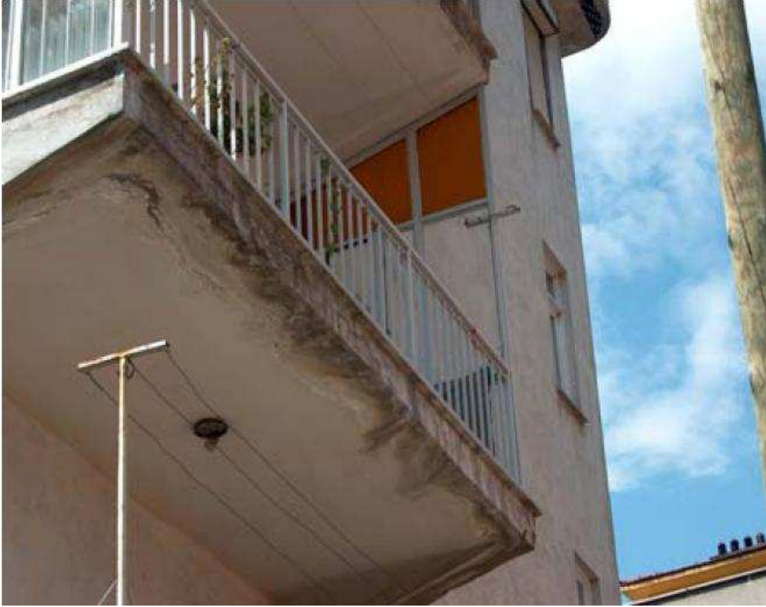
Şekil 3.2. Balkonda damlalık yapılmadığı için binanın önyüzünde hasar oluşması
