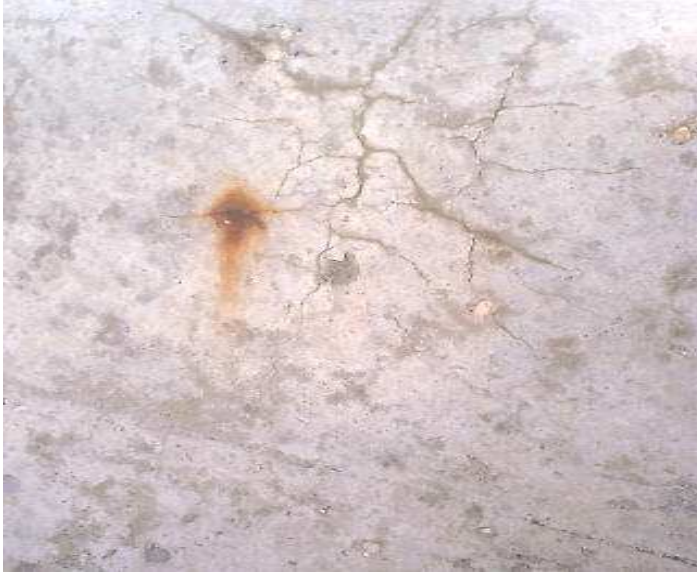
Şekil 3.10. Donatı korozyonu sonucu pas tabakasının beton yüzeyine sızması
