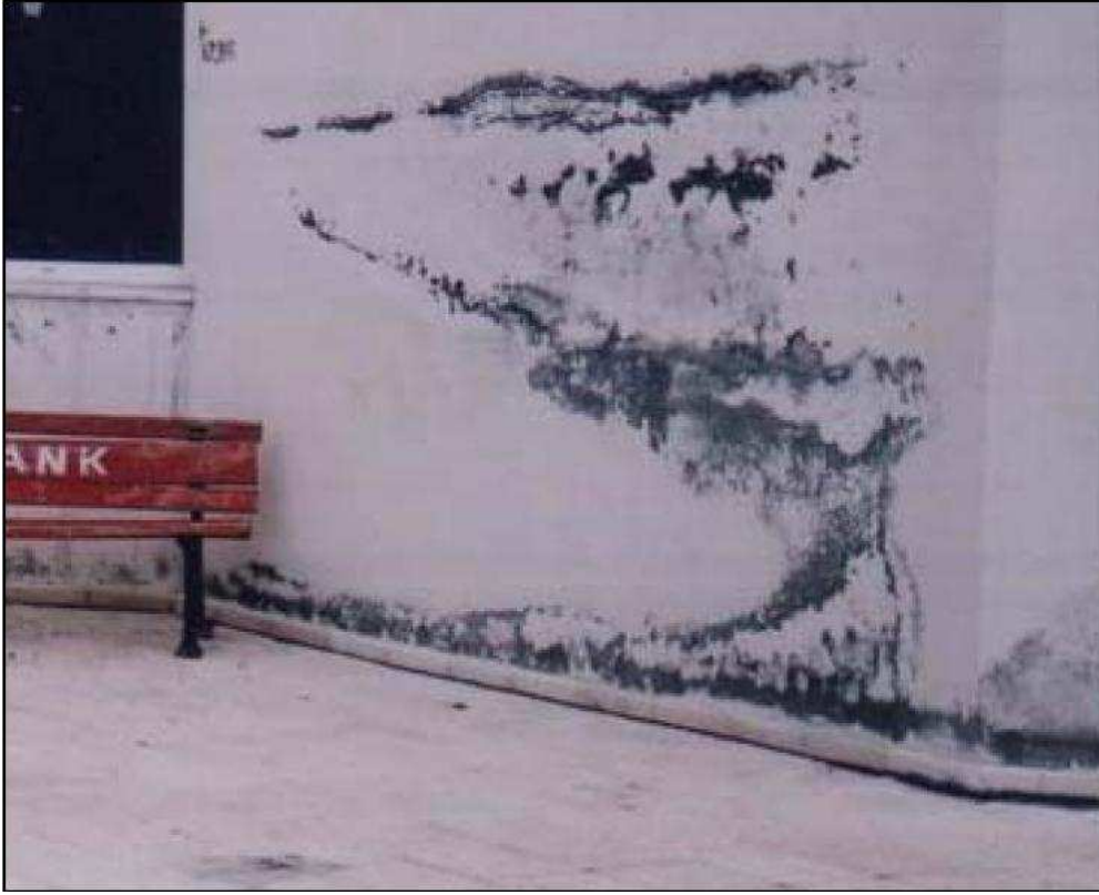
Şekil 3.6. Gerekli yalıtımın yapılmaması sonucunda zarar gören yapı
