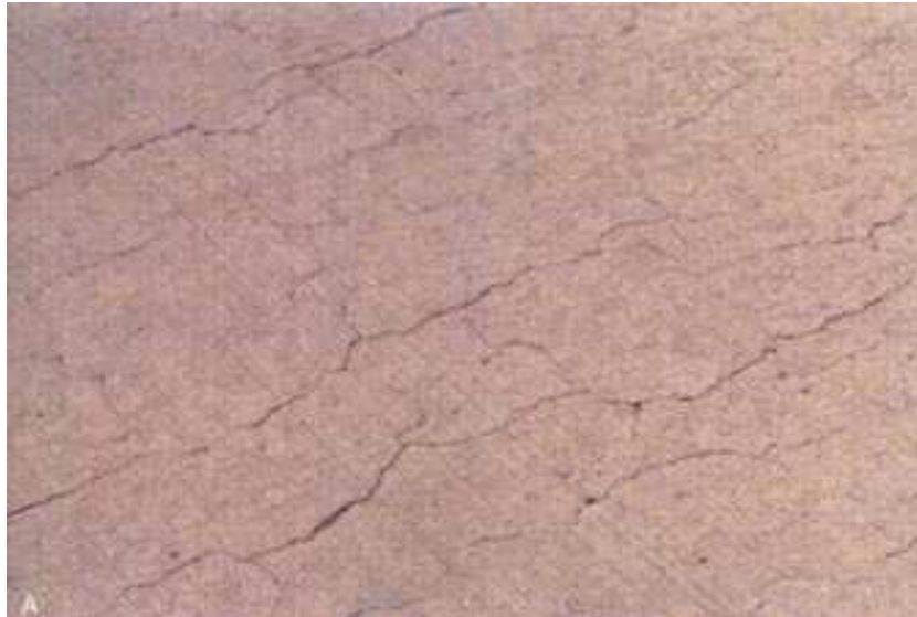
Şekil 3.12. ASR hasarına bağlı olarak oluşan çatlaklar
