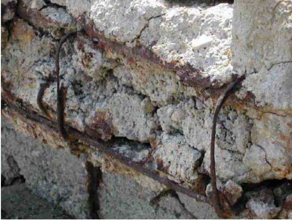
Şekil 3.7. Korozyon sonucu donatıların zarar görmesi
