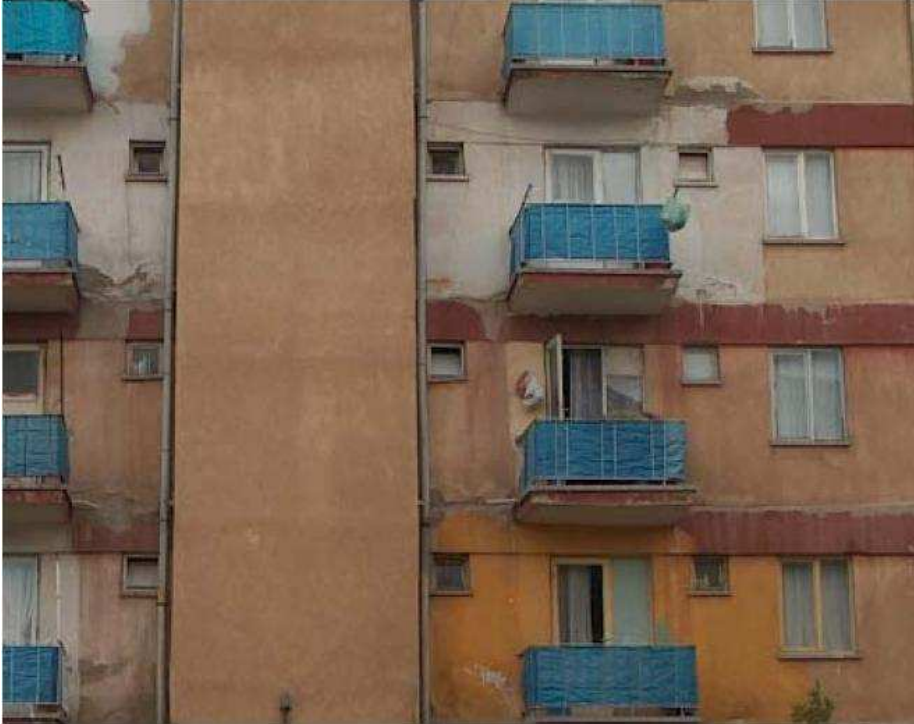
Şekil 3.1. Yanlış detay uygulamaları binanın ön yüzünde hasara neden olur
