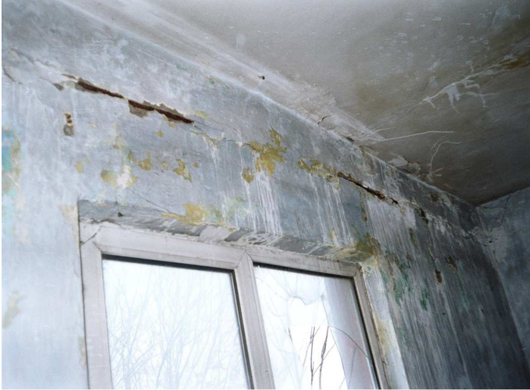
Şekil 3.11. Donatı korozyonu sonucu donatının açığa çıkması
