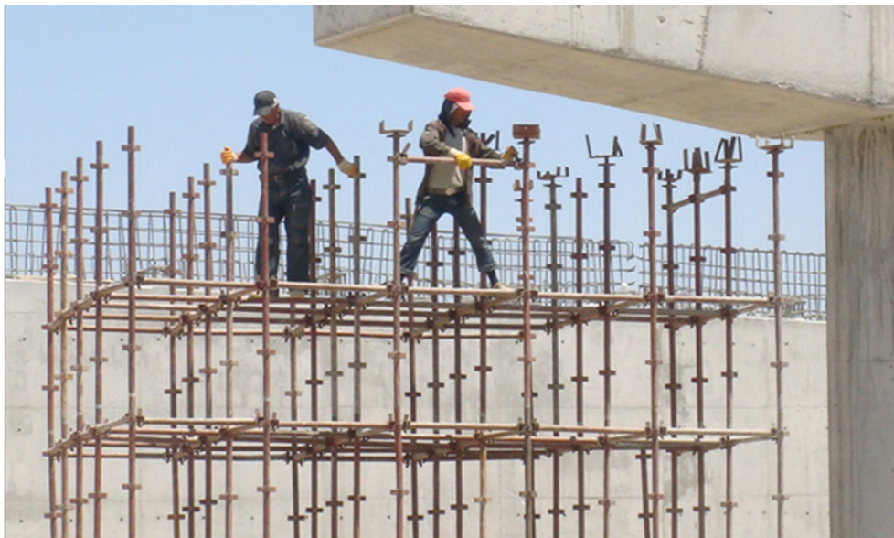
Şekil 3.20. Ahşap-Demir iskelede emniyet kemersiz çalışma [6]
