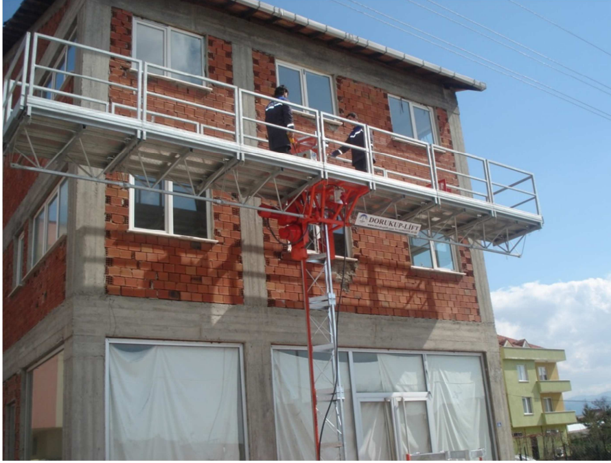
Şekil 3.15. Hareketli Cephe İskele sistemleri
