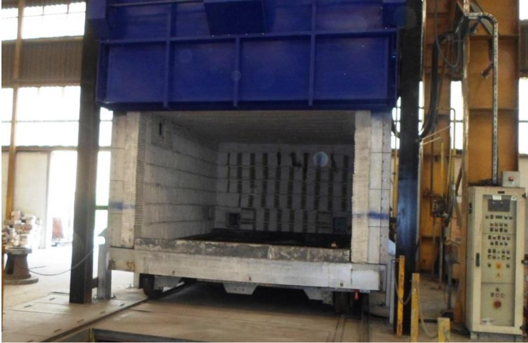
Şekil 4.4. Akmetal Metalurji Endüstriisi A.Ş. bünyesinde Emtav marka doğal gaz fırını
