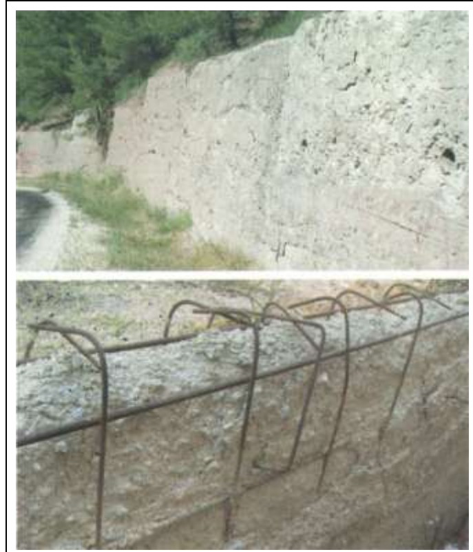
Şekil 4.4. Donma-çözünme hasarlı yapı elemanları[23]
