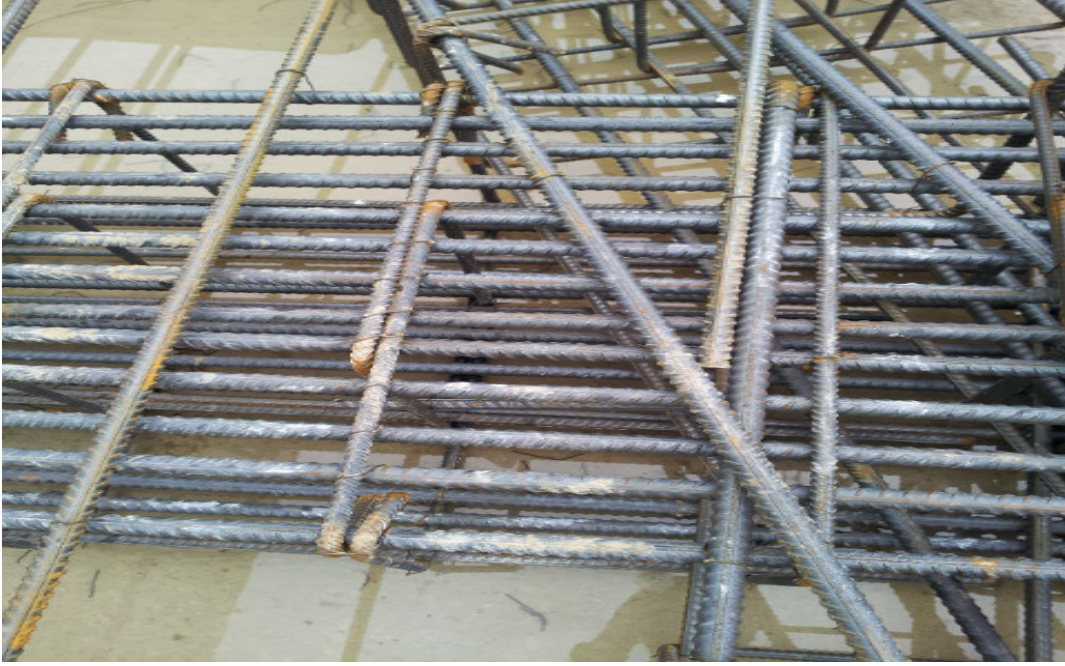
Şekil 3.35. Temel kirişlerinde boyuna donatı çubukları arasındaki mesafe şartı sağlamaması durumu
