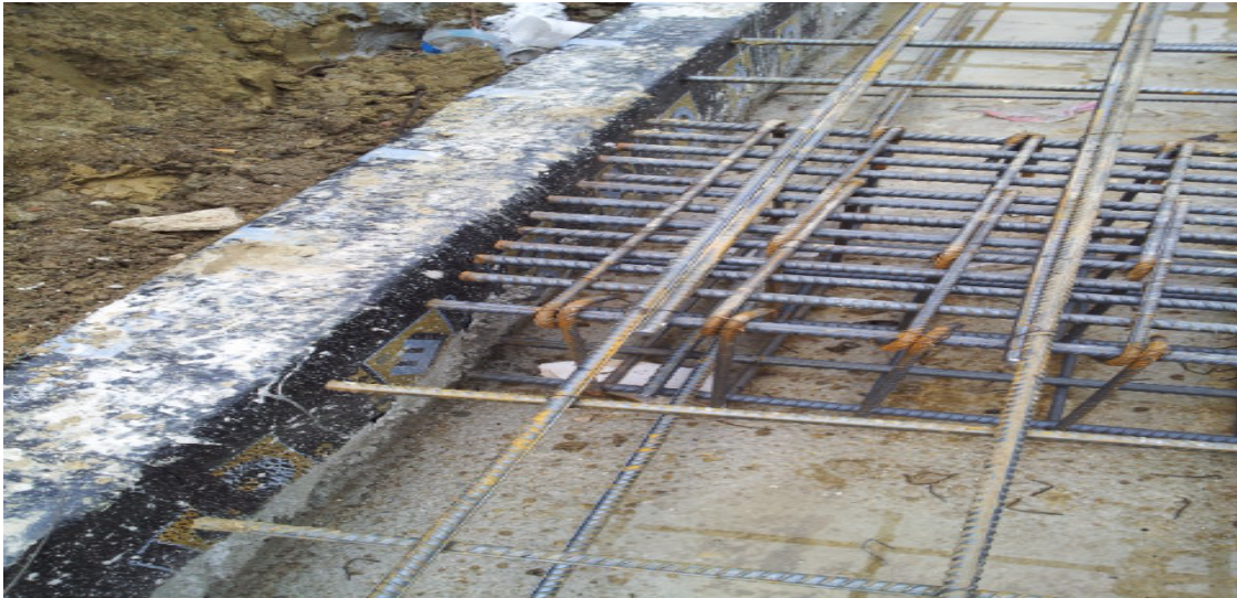
Şekil 3.36. Temel kirişlerinde donatıların 90 derece kıvrılmaması durumu
