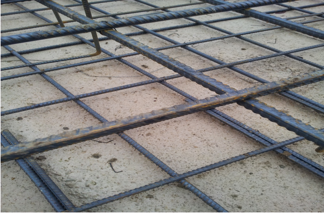
Şekil 3.34. Temelerde net beton örtüsü şartına uyulmaması durumu
