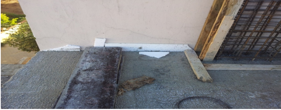
Şekil 3.5. Dilatasyon derzi şartına uyulmaması durumu
