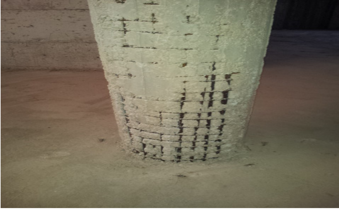
Şekil 3.11. Kolonlarda net beton örtüsü şartına uyulmaması durumu
