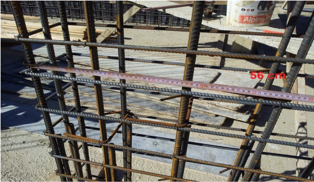
Şekil 3.4. Enine donatı kolları ve/veya çirozlar arasındaki en büyük mesafe şartına uyulmaması durumu
