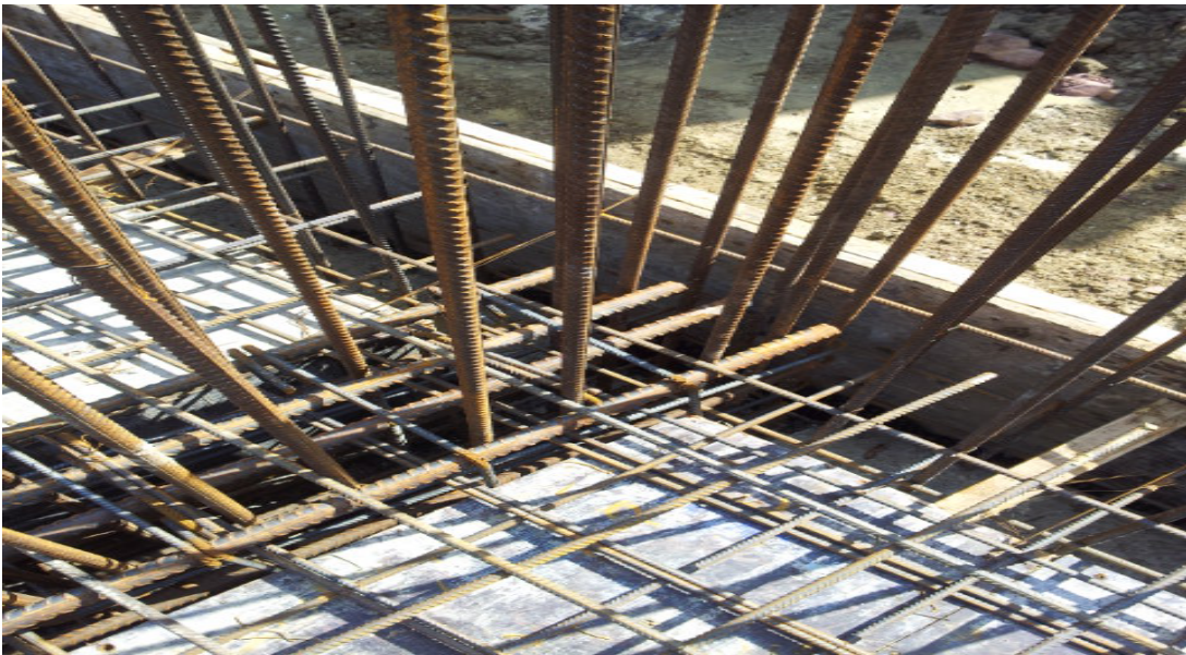
Şekil 3.13. Kirişlerin donatılarının 90 derece bükülmesi şartına uyulmaması durumu
