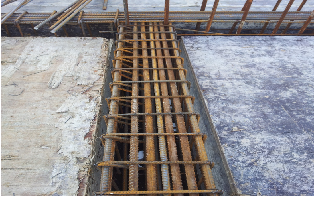
Şekil 3.12. Kirişlerde boyuna donatı çubukları arasındaki mesafe şartına uyulmaması durumu
