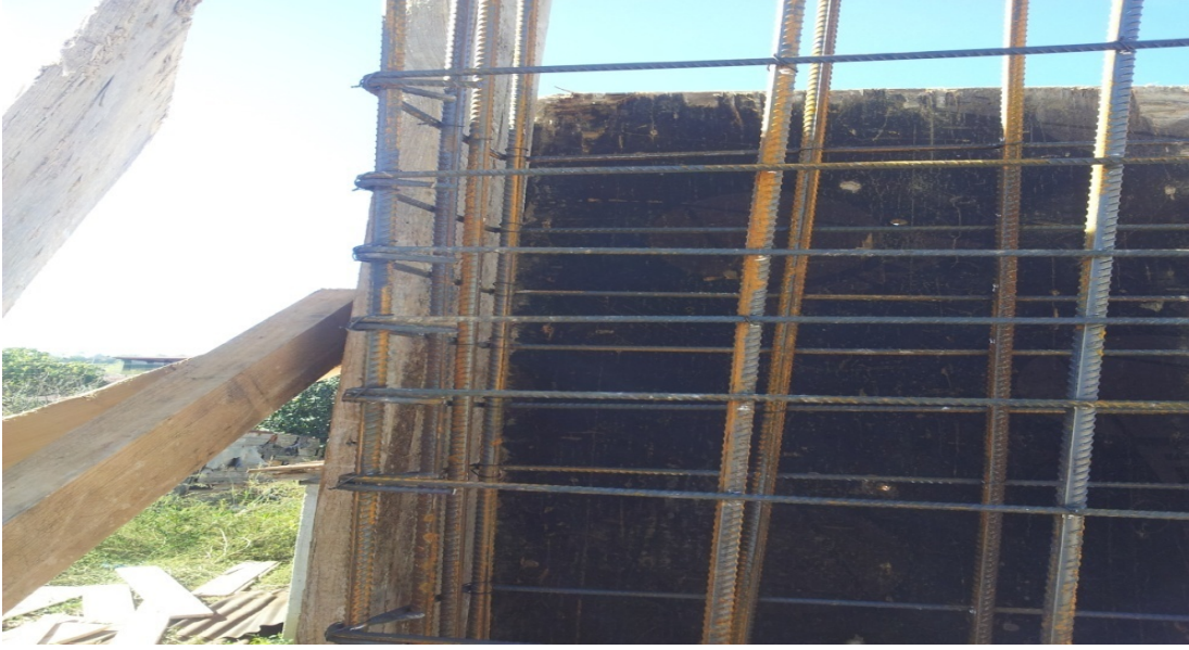
Şekil 3.6. Enine donatı kanca boyu şartına uyulmaması durumu
