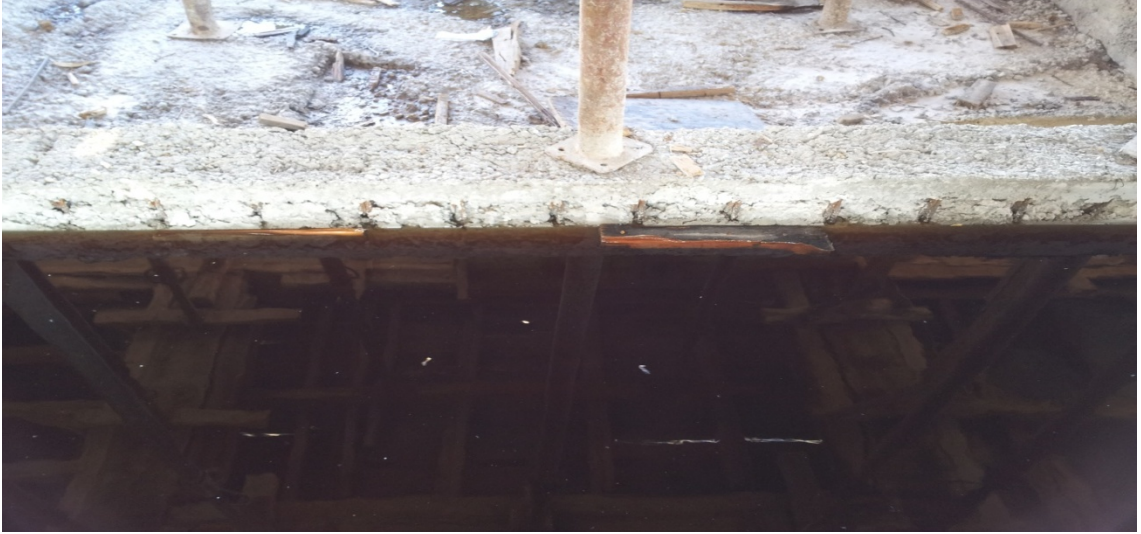
Şekil 3.19. Kirişlerde net beton örtüsü kalınlığı şartının sağlanmaması durumu
