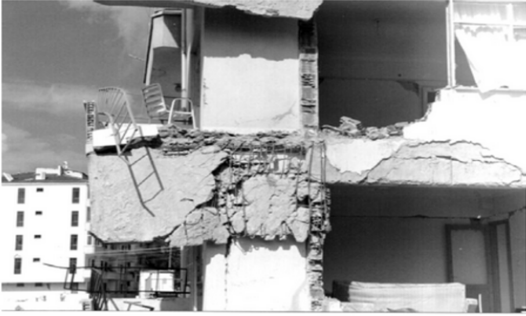
Şekil 2.6. Donatı yerleştirme hatası sebebiyle meydana gelen konsol hasarı
