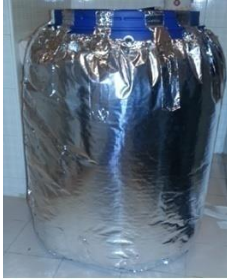
Şekil 5.10. Su deposunun yalıtılmış hali
