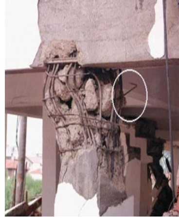
b) Uygun kanca yapılmamış
