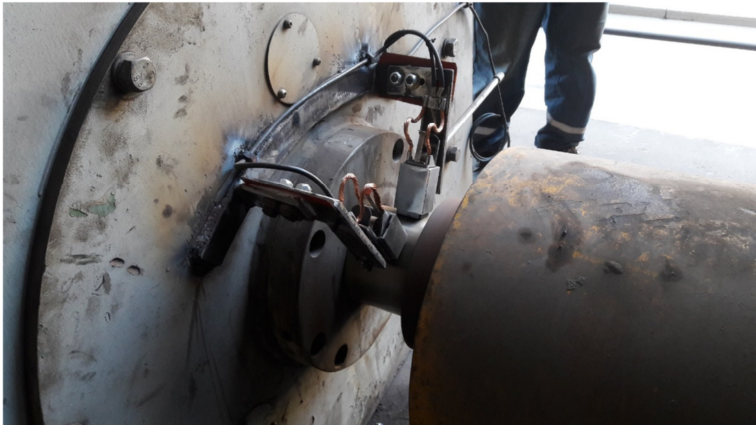
Şekil 4.3. PA Fan elektrik motor rotorunun mil üzerinden topraklanması
