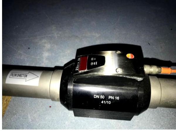
Şekil 4.11. Compressed Air Flowmeter
