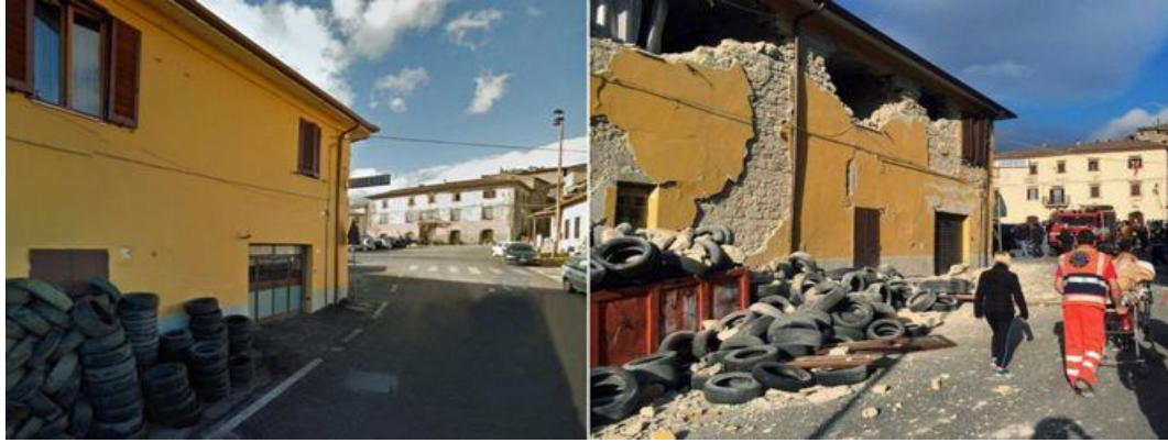
Şekil 1.6. 2016 İtalya-Accumoli depreminde hasar görmüş bir yığma yapı [7]
