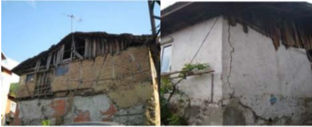
Şekil 1.15. 2011 Kütahya depreminde hasar gören yığma yapı örnekleri [16]
