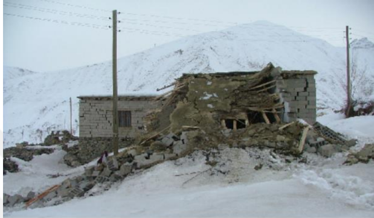
Şekil 1.13. 2005 Hakkari depreminde hasar gören bir kırsal yapı [19]
