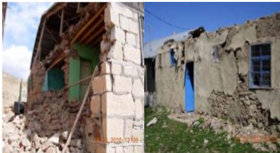
Şekil 1.14. 2010 Elazığ depreminde hasar gören bazı yığma yapılar [16]
