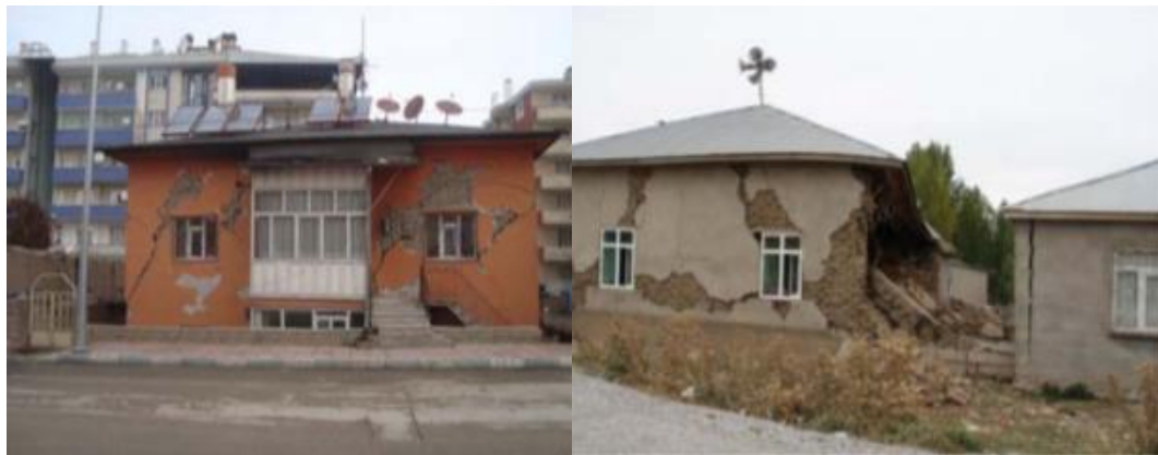
Şekil 1.16. 2011 Van depreminde hasar gören yığma yapı örnekleri [16]
