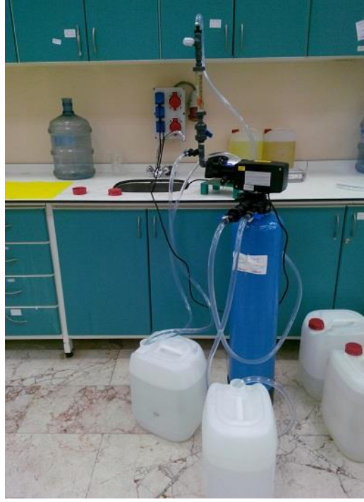
Şekil 3.11. KF + klorlama pilot tesisi
