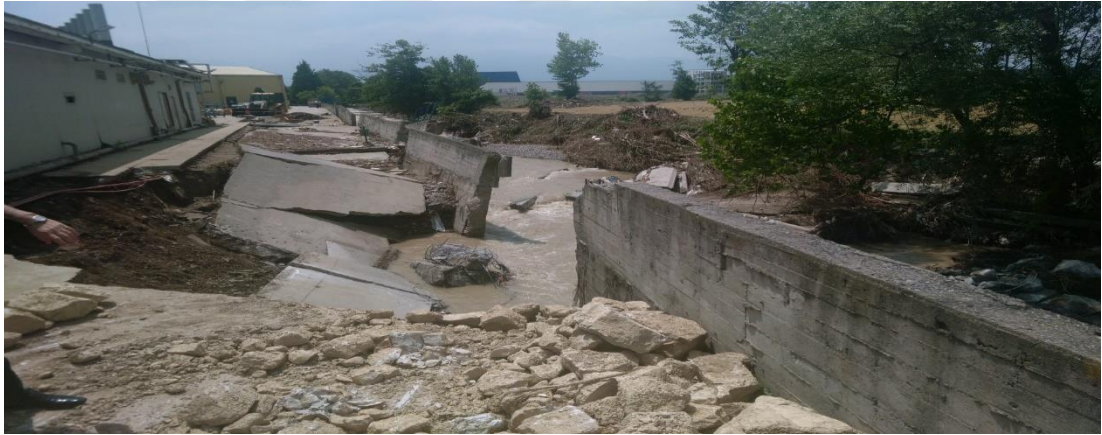
Şekil 5.7. Taşkın sonrası Çak Teksil fabrikası civarı (DSİ,2014)
