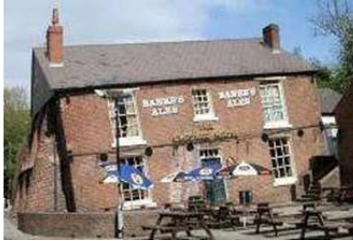
Şekil 2.14. Temel oturmasından kaynaklı yapıda meydana gelen hasar [42]
