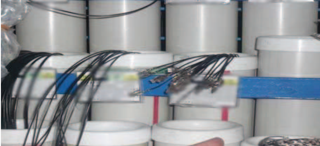
Şekil 4.4. Kablo besleme ünitelerinin iyileştirme öncesi durumu.
