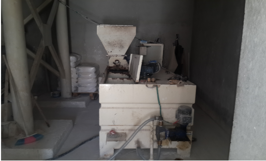
Şekil 2.3. Arıtma çamuru şartlandırma ünitesi
