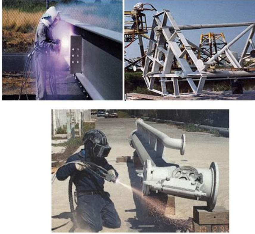
Şekil 3.6. Korozyona karşı kaplama uygulamaları [35].
