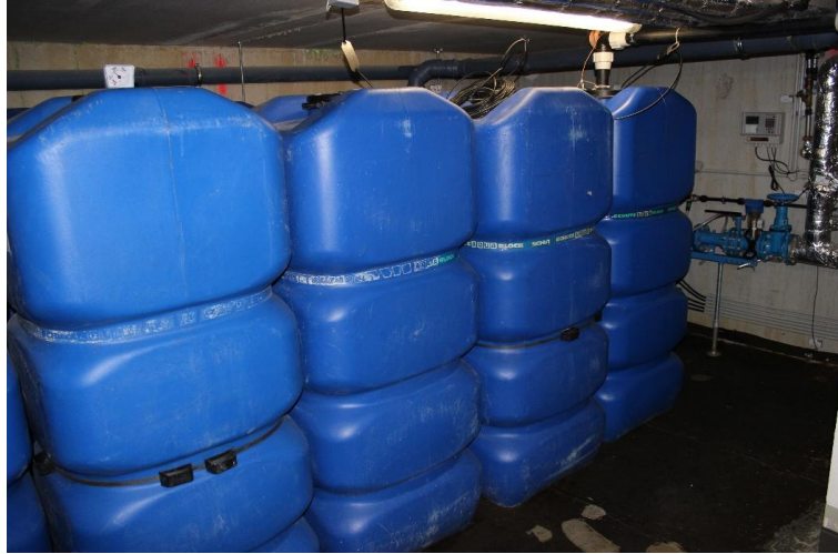
Şekil 51: Yağmur Suyu Depolama ve Pompalama Alanı
