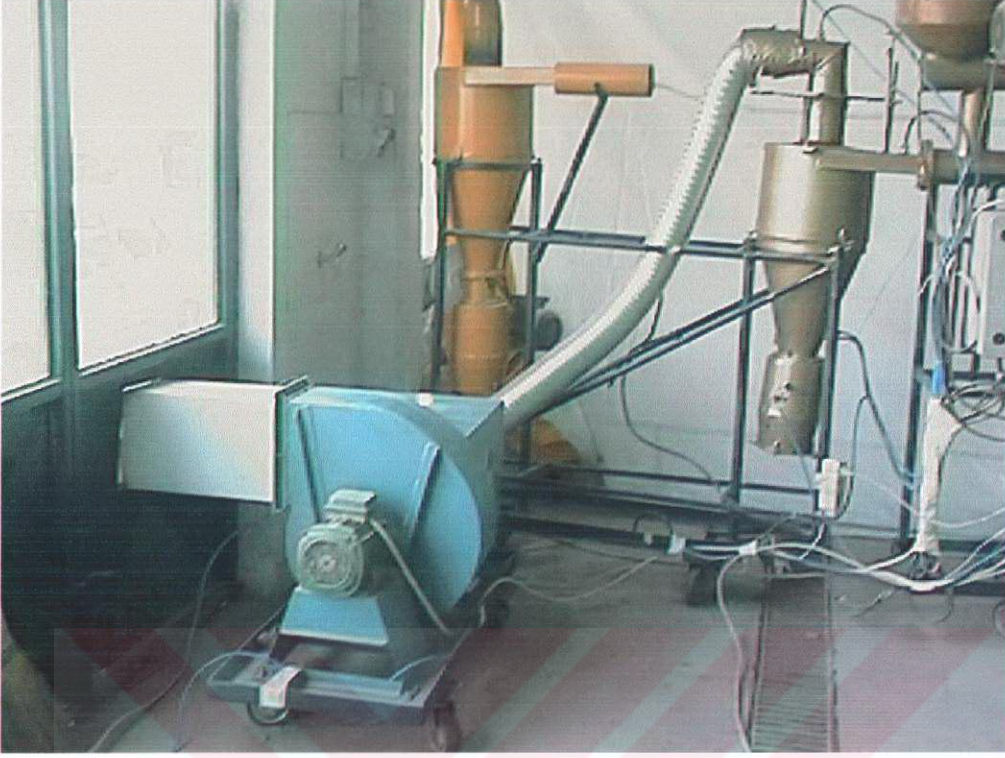
Şekil 5.22 Önısıtıcı siklon ve vantilatör Bağlantısı
