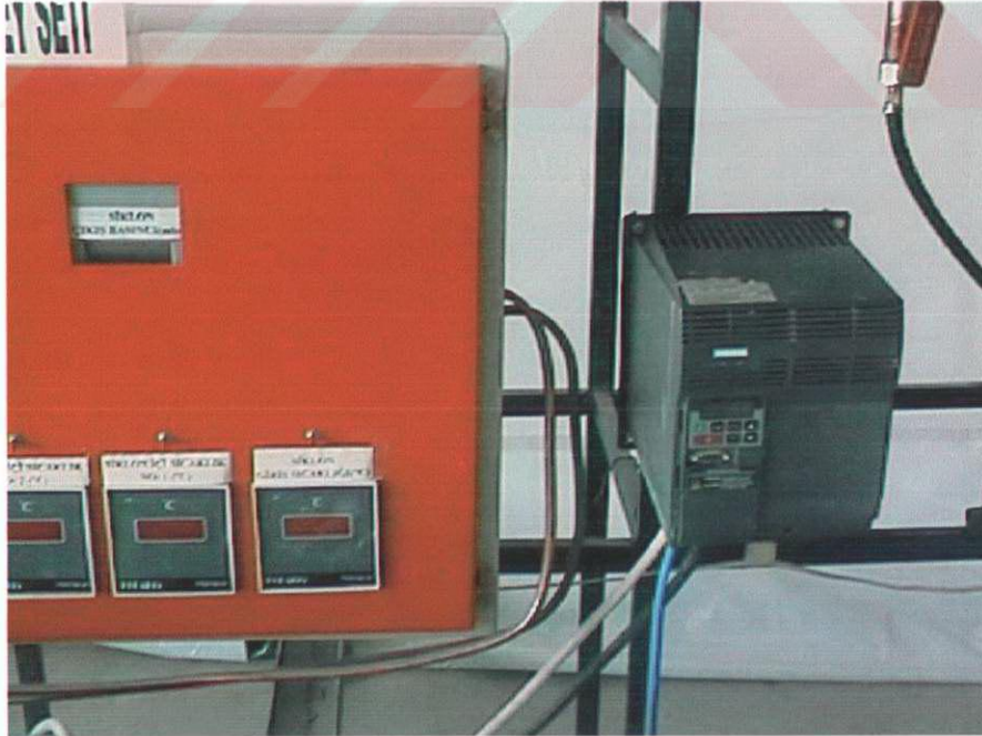
Şekil 5.15 Vantilatöre yol veren frekans invertörü
