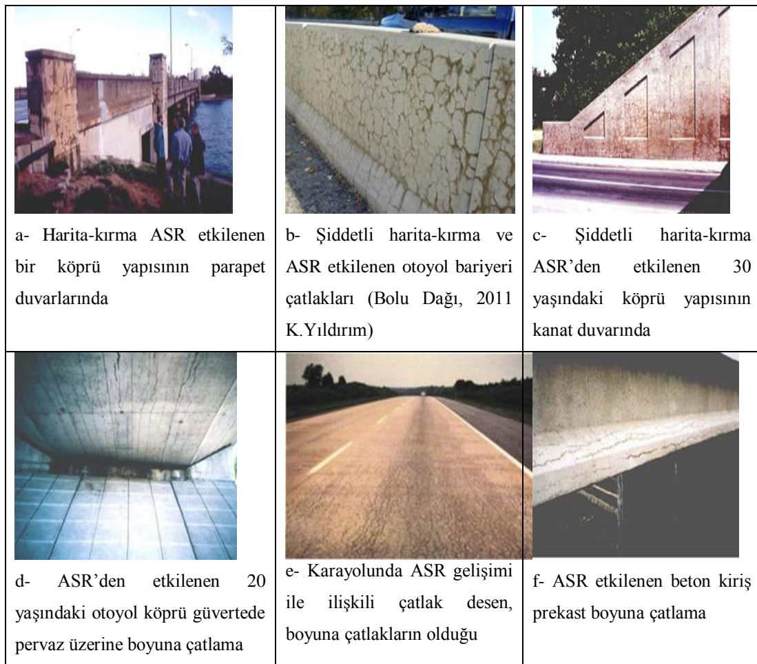
Şekil 2.9. ASR hasarına maruz kalmış yapı elamanlarından görüntüler [40].
