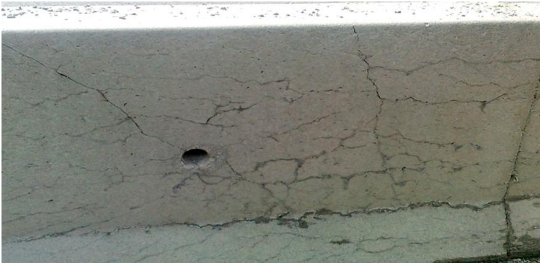
Şekil 2.3. Karayolu yol bariyerinde gözlenen ASR çatlakları (Bolu 2011)
