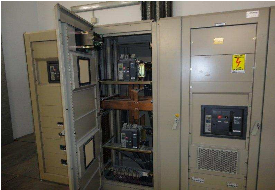
Şekil 4.5. Birinci işleme takılmış ION 7650 enerji analizörü ( bara görünüşlü )
