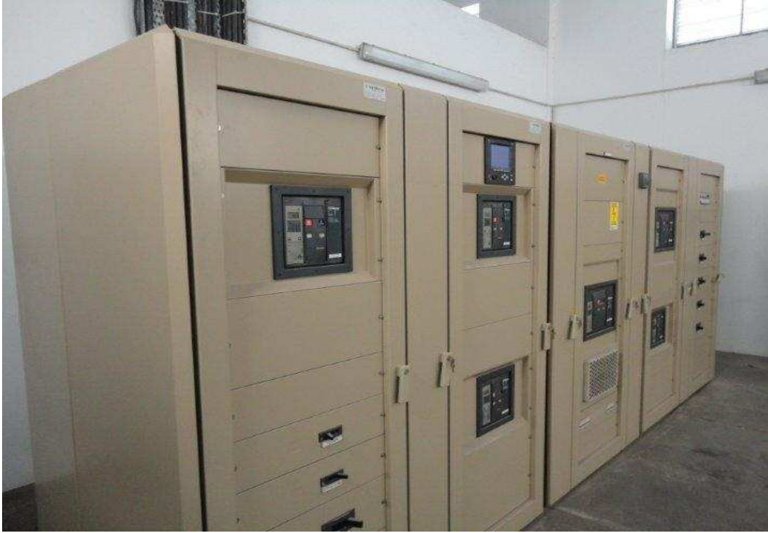
Şekil 4.4. Birinci işleme takılmış ION 7650 enerji analizörü
