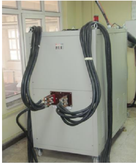
Şekil 4.1. Elektrik güç kaynağı olarak kullanılan redresör
