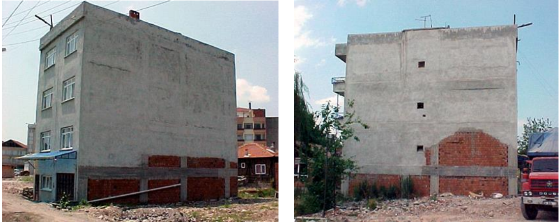
Şekil 2.2. Yenigün mahallesinde doğu ve kuzey yönünde yer değiştiren yapı fotoğrafları ( http://peer.berkeley.edu/publications/turkey/adapazari/index.html )
