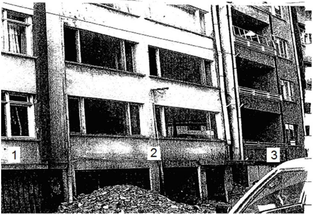
Şekil 3.5. (2) ve (3) nolu yapıların birleşim yerinin deprem sonrasındaki durumu (Avrasya zemin müh. müş. inş. san. ve tic. İtd. Şti., 2002)
