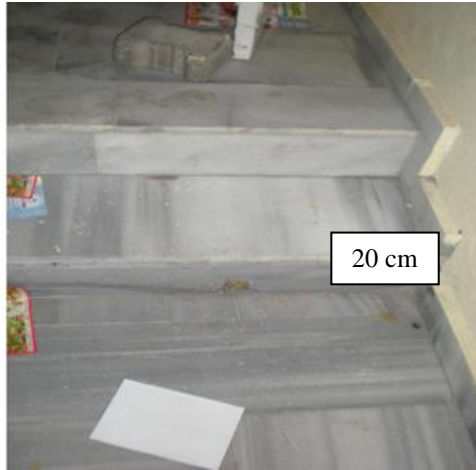
Şekil 3.10. (3) nolu yapıda güçlendirme yapıldıktan sonra bugün itibarı ile görülen oturma
