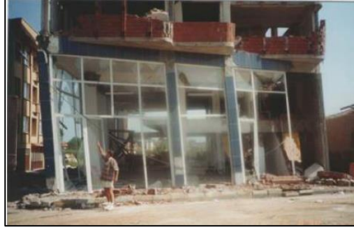
Şekil 1.1. Kocaeli depreminde yumuşak kat ve zayıf kat nedeniyle oluşan hasar [10].
