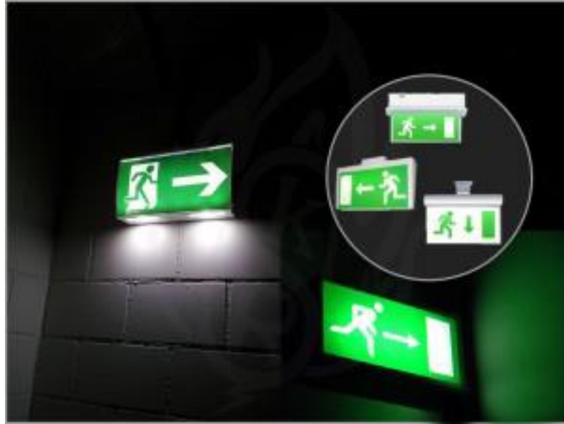
Şekil 2.8. Acil durum aydınlatma ve yönlendirme sistemleri
