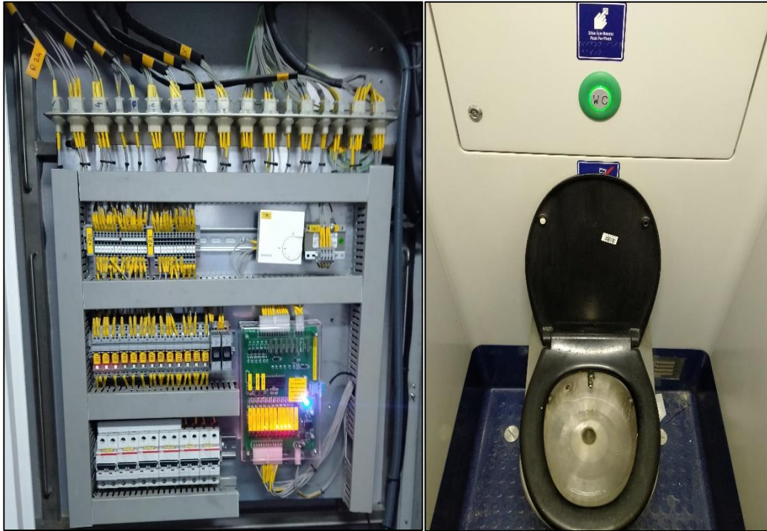
Şekil 4.4. VTS elektrik paneli (solda) ve tuvalet kabininin görünüşü (sağda).
