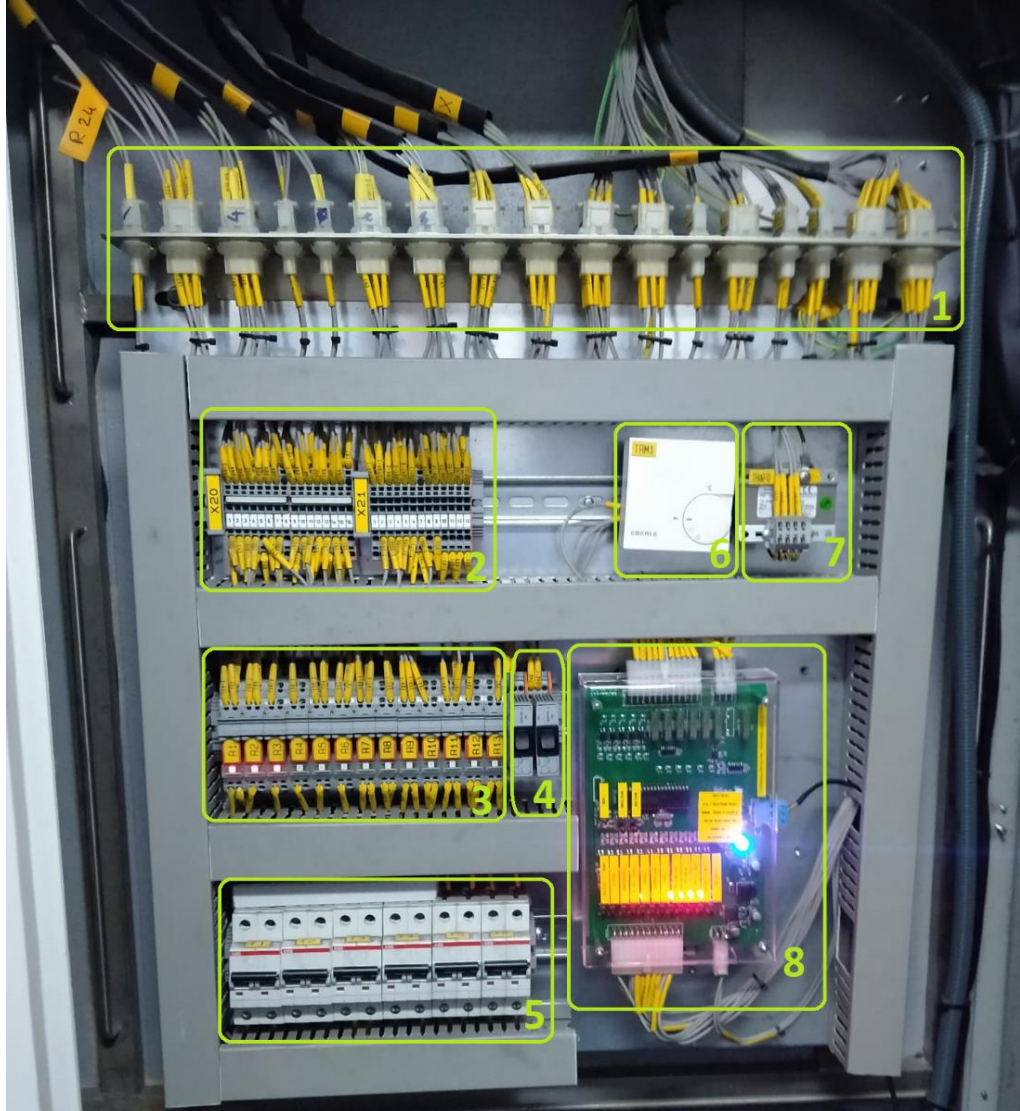
Şekil 3.3. VTS elektrik paneli.
