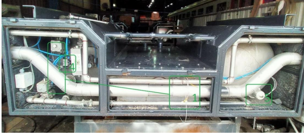
Şekil 3.4. Atık ve temiz su tankı tertibatı.
