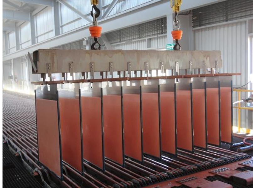
Şekil 2.16. Bakır elektro-rafinasyon tankı (Copper Alliance, 2022).
