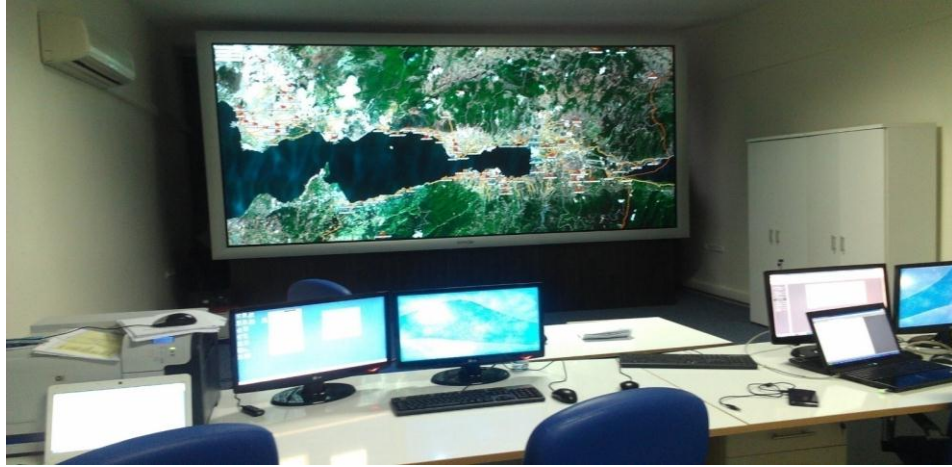
Şekil 3.1. İSU Genel Müdürlüğü Scada sistemi kontrol merkezi
