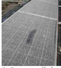
Şekil 3.8. Güneş panelinde tozlanma
