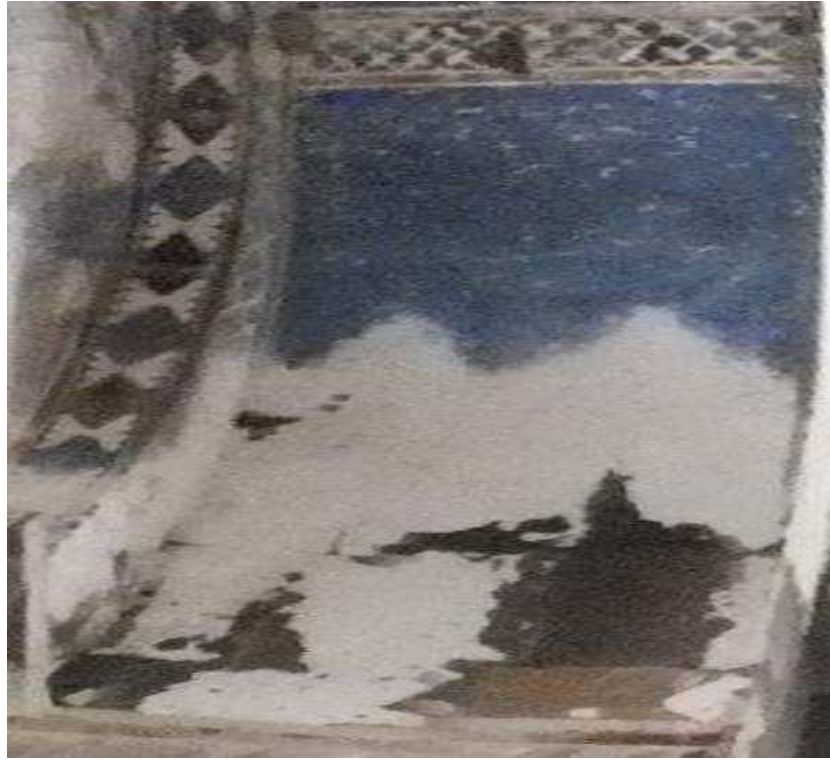
Fot. 158: Resimli Kilise, güney haç kolu kemeri duvar resmi. Cebrail tasvirinin bulunması gerektiği Müjde konulu duvar resminin karşı duvarı.
