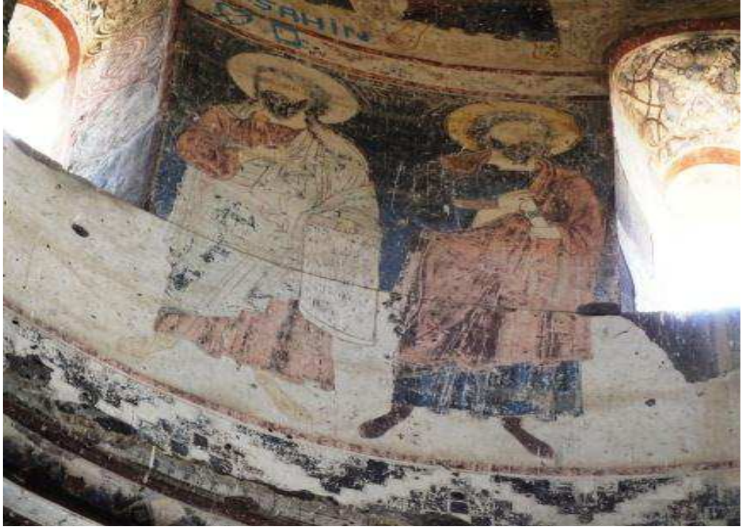
Fot. 209: Resimli Kilise, kubbe kasağı alt kısım duvar resmi.
