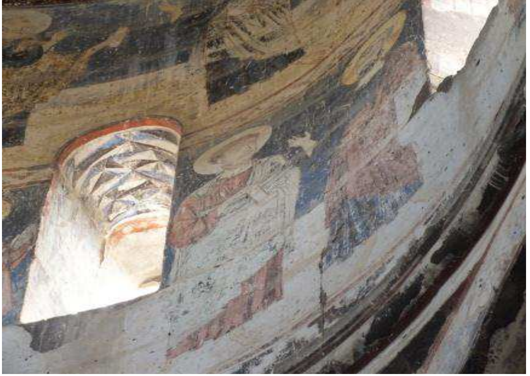
Fot. 211: Resimli Kilise, kubbe kasağı alt kısım duvar resmi.
