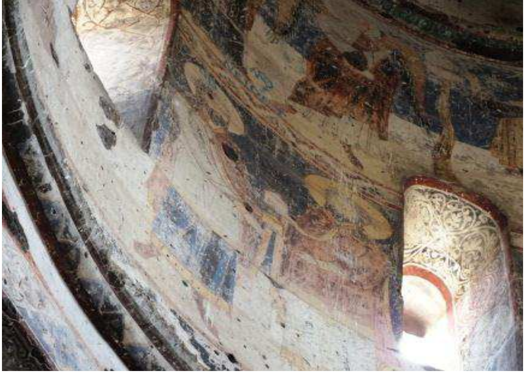
Fot. 208: Resimli Kilise, kubbe kasağı alt kısım duvar resmi.
