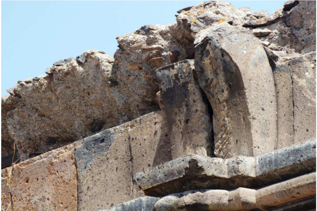
Fot. 4: Gürcü Kilisesi, üst örtü takviye kemerler kalıntıları.
